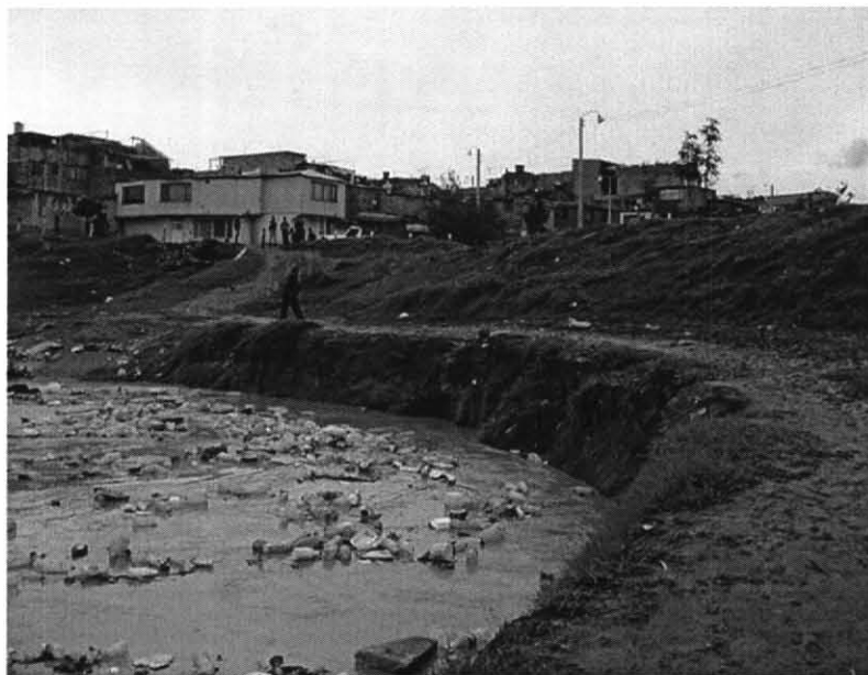
Foto 3. Vista hacia aguas arriba del río Tunjuelito en la estructura de control de inundaciones No. 3 en la localidad de Bosa. Obsérvese la cantidad de basuras que pueden generar taponamiento y represamiento de aguas.
