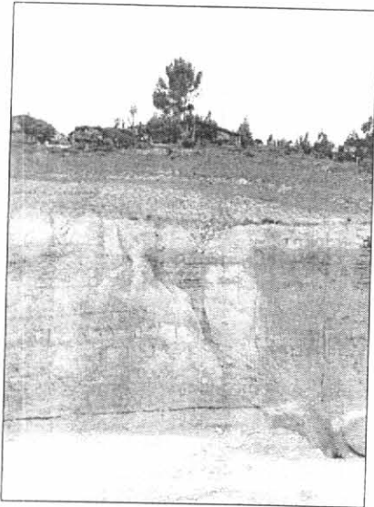
Fotografía 7 Superficie de falla al norte
