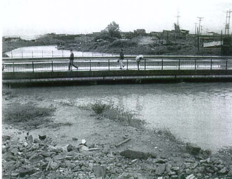
Foto 3. (Mayo 31 –2002, 10:42 AM). Costado aguas arriba del puente sobre el río Tunjuelo en el barrio Meissen. El nivel del agua ha superado el nivel inferior de las vigas del puente.
