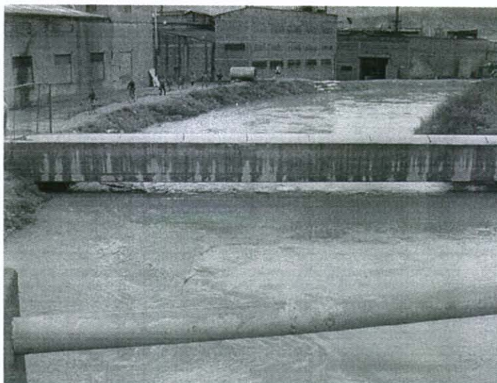
Foto 7. (Mayo 31 –2002, 12:00 AM). Río Tunjuelo. Paso de la tubería de la estación de Bombeo San Benito de la EAAB. El nivel del río está aproximadamente a 1 metro de la parte inferior de esta estructura .
