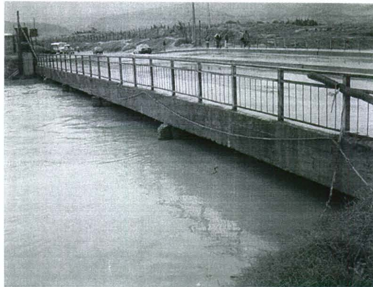
Foto 1. (Mayo 31 –2002, 10:42 AM). Puente sobre el río Tunjuelo en el barrio Meissen. El nivel del río está a 50 cm de la loza del puente.
