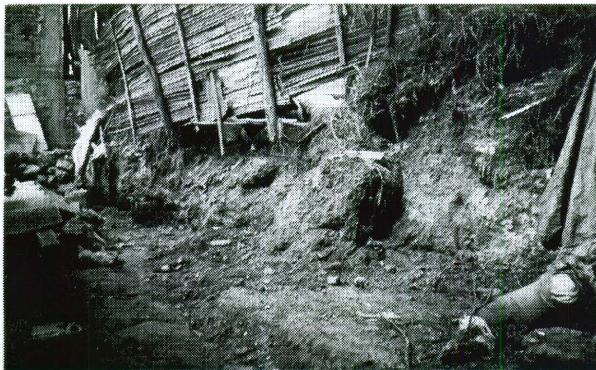
2. Zona deslizada desde el solar de la casa de la Calle 72 Sur No 19F-31.
