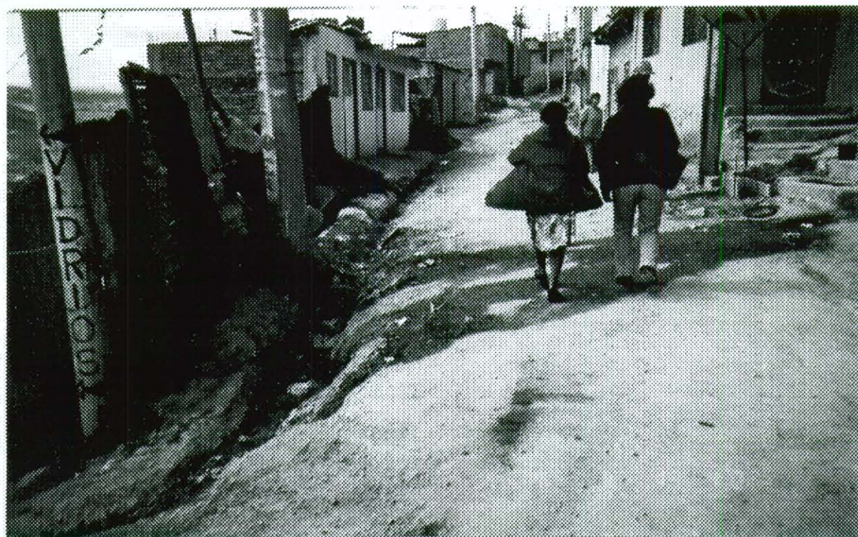
1. Corona del deslizamiento en la carrera 20, se aprecia la cuneta construida por la comunidad y el poste de Codensa, amenazado.
