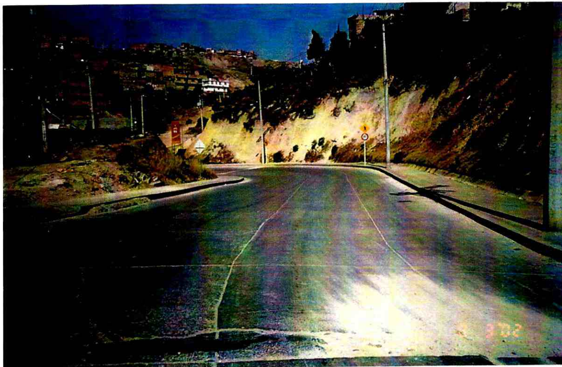
1. Talud norte de la carrera 38ª.
