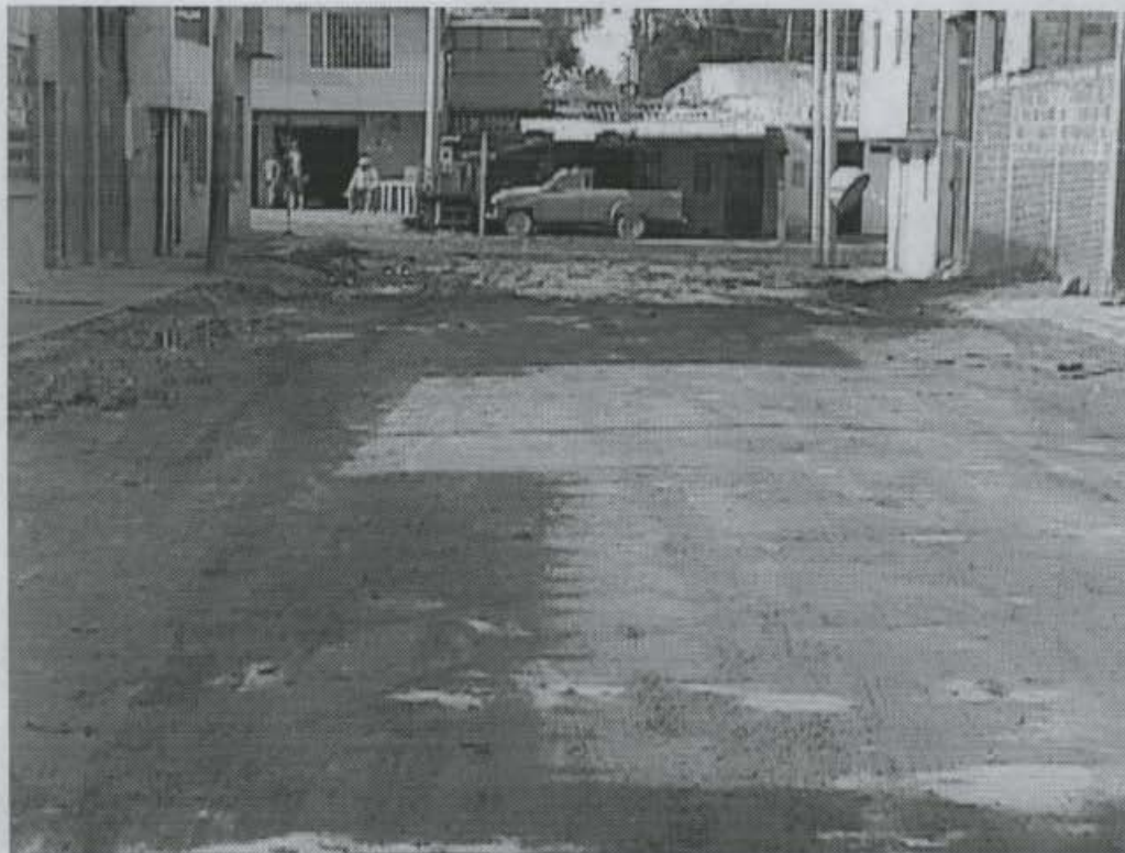
FOTO 4. Carrera 41 de sur a norte. Al fondo la calle 199, que es una de las más afectadas por el reflujó de aguas del alcantarillado.
