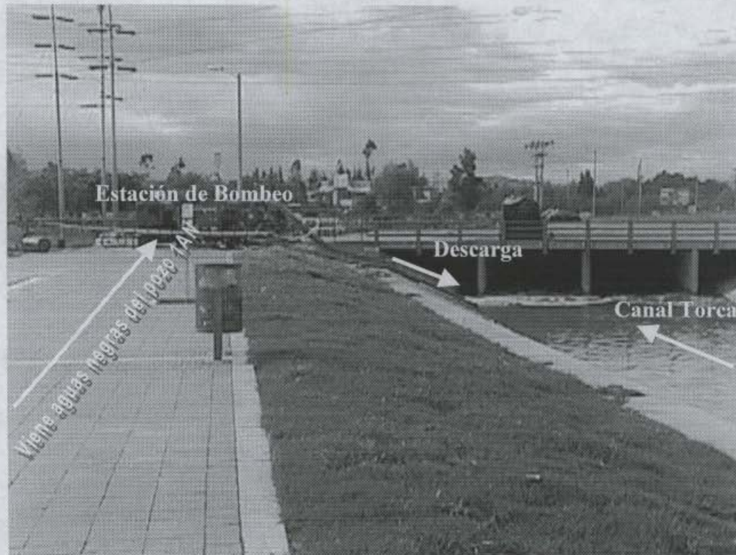
FOTO 10. Estación de Bombeo de Aguas Negras. La estación cuenta con dos bombas eléctricas de 16" cada una permanentemente. El día de la visita se tenían 3 bombas adicionales instaladas en los fosos de bombeo (1 de 10" de la DPAAE y 2 de 6" c/u de la EAAB)
