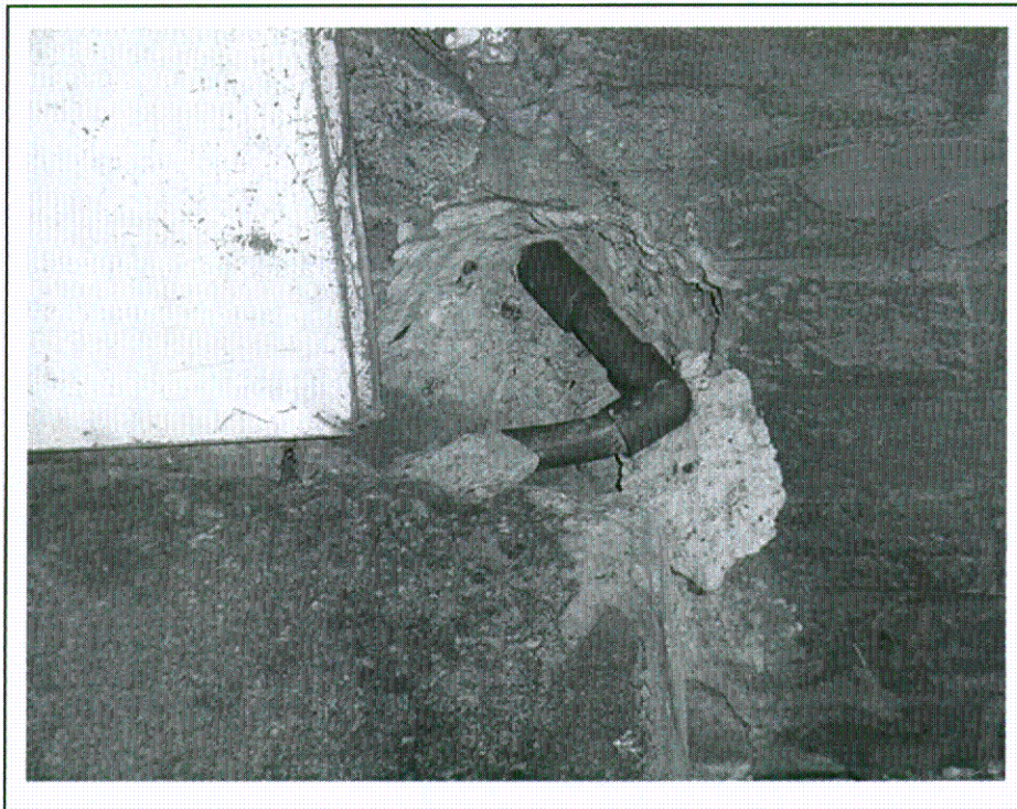
FOTOGRAFIA 3. Deformación de la tubería de Acueducto
