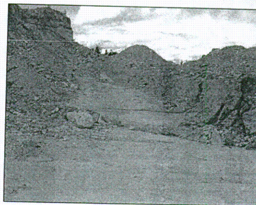
Fotografía 3 Escalonamiento de grietas en el patio de cantera
