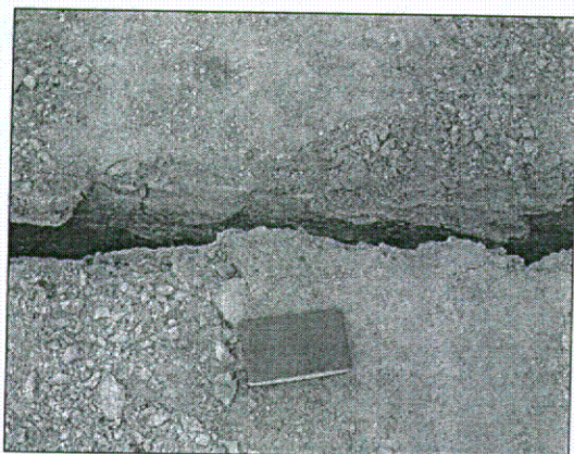
Fotografía 2 Detalle grietas piso del patio de explotación
