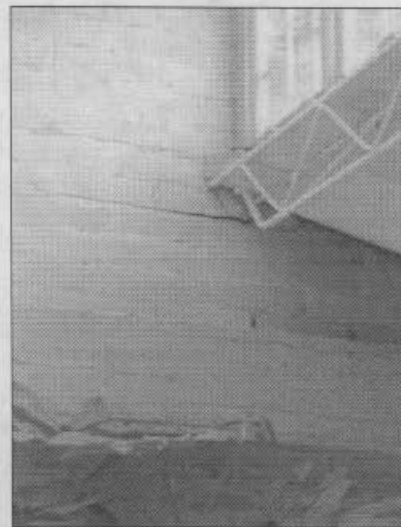
Fotografía No. 14 Soporte deficiente de la cercha del baño nuevo
