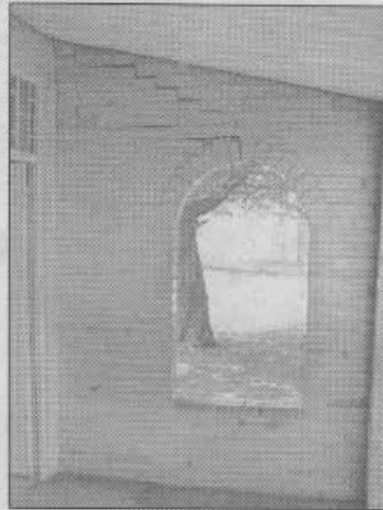
Fotografía No. 15 Falla del arco en mampostería a la entrada del baño nuevo
