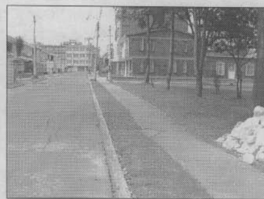
Fotografía No. 3 Hundimiento del andén y la vía
