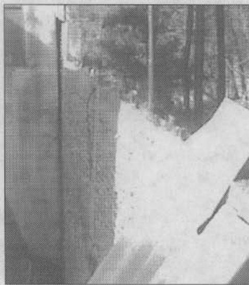
Fotografía No. 8 Nótese la separación entre muros de culata en la parte alta, la altura del muro y proximidad de los árboles.
