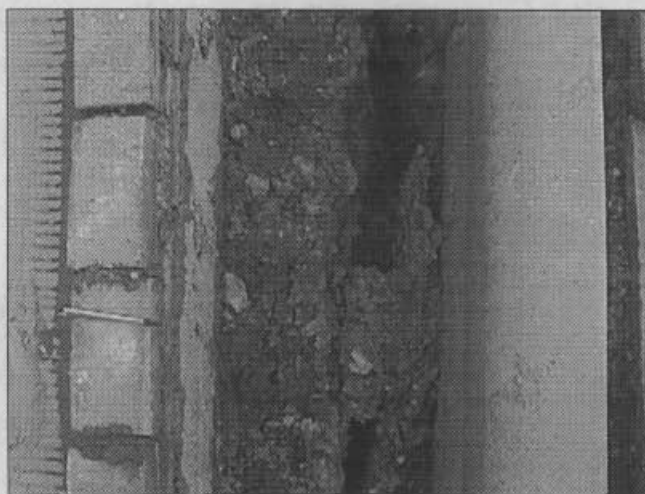
Fotografía No. 6 Detalle de apertura entre la placa de pavimento y el sardinel. Los vecinos construyeron con ladrillos una barrera para impedir el acceso de agua en la grieta.
