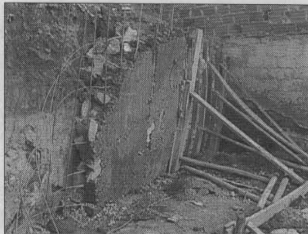
Fotografía No. 5 Detalle de la obra de estabilización realizada por el propietario del lote.
