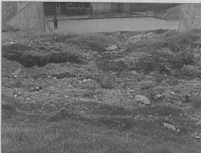
Fotografía No. 3 Vista en sentido oriente - occidente. Nótese la abertura de las grietas de corte.
