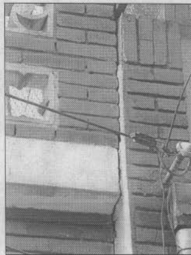
Fotografía No. 7 Separación de muros de culata
