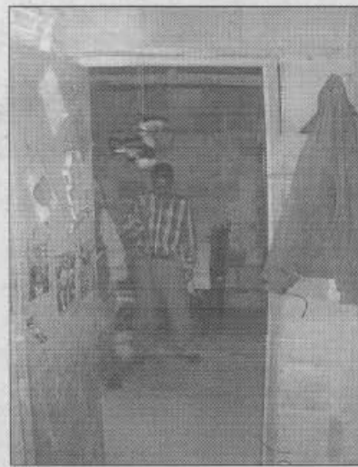
Fotografía No. 4 Deformación de los muros y marcos de las puertas
