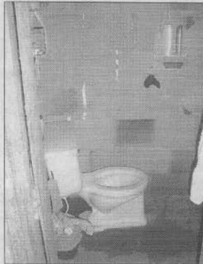
Fotografía No. 3 Grieta de tracción en el baño
