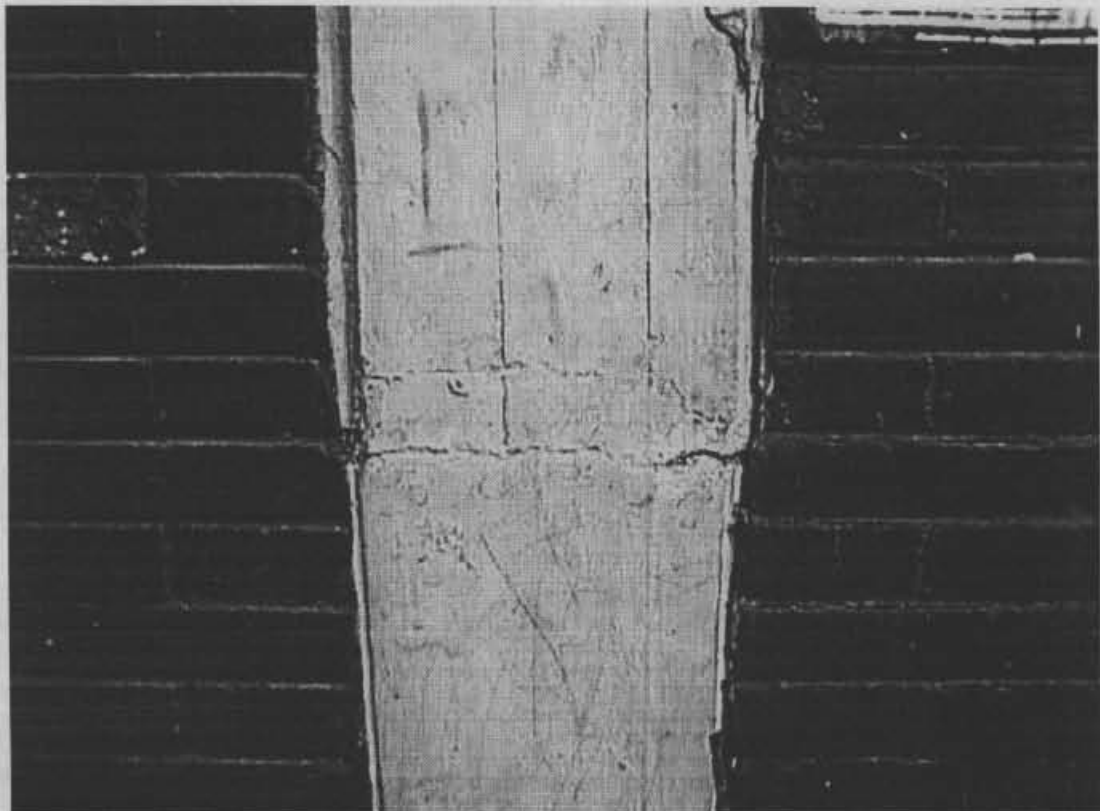
Fotografía No. 6. Detalle de la deficiencia constructiva. La columna se construyó por secciones, cuando debió haber sido monolítica.
