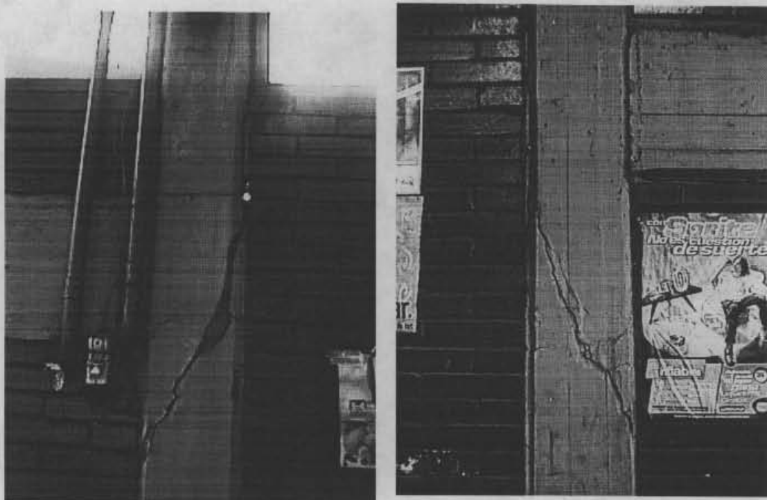
Fotografías No. 4 y 5. Grietas a 45° en las columnas del frente norte de la plaza.
