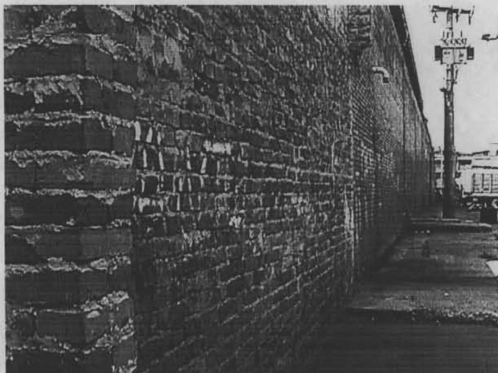
Fotografía No. 9. Muro del extremo norte de la plaza del 20 de Julio. En este sector se localizan la mayoría de las columnas que presentan las fallas descritas previamente.
