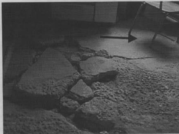
Fotografía 4. Destrucción parcial de la placa de piso e inclinación de la misma.
