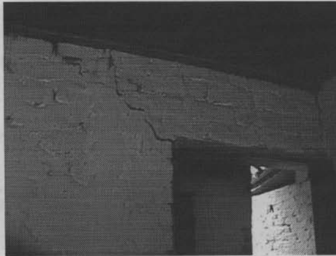
Fotografía 3. Presencia de grietas en los muros transversales de la vivienda.
