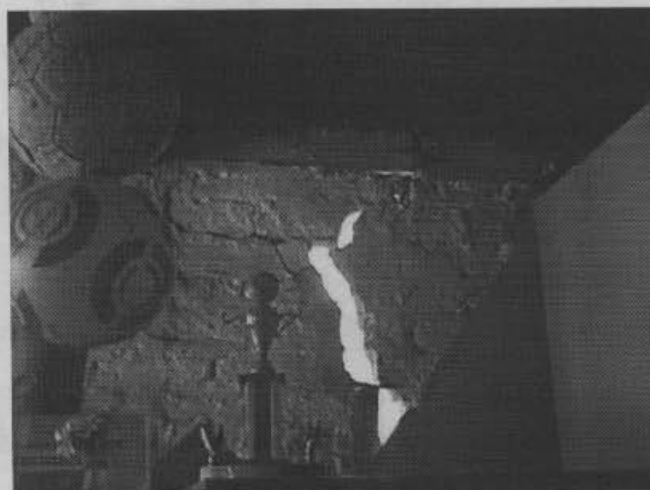
Fotografía 2. Grietas con apertura hasta de 6 cm en el muro lateral derecho - parte delantera de la vivienda de propiedad de la señora Anita Ramos Rodríguez.
