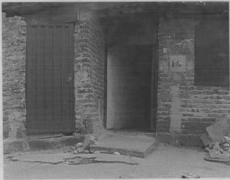
Fotografía 5. Deformaciones y corrimientos del eje principal de los muros laterales.
