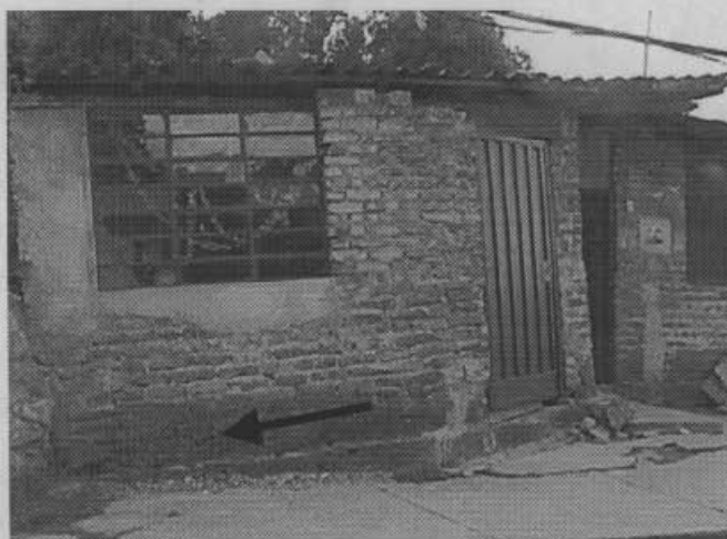
Fotografía 1. Inclínación de la vivienda localizada en la calle 13 sur No. 16 - 85 Este.
