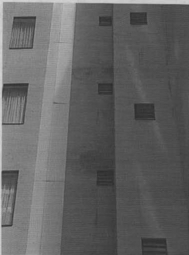
Fotografía No. 3. Panorámica del edificio donde se ubica el salón comunal. Se observa el flanche cubriendo la separación diferencial de la junta de dilatación y los problemas de humedad en los muros externos.
