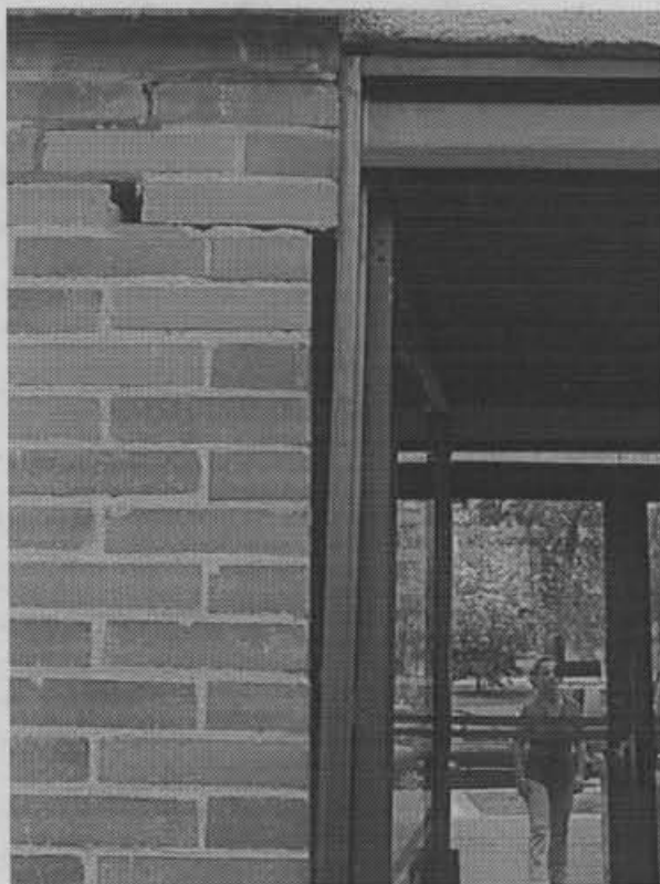
Fotografía No. 6. Otro de los muros de la caseta de acceso. Nótese la separación diferencial del marco metálico con respecto al muro en ladrillos y el desprendimiento de parte de este muro.
