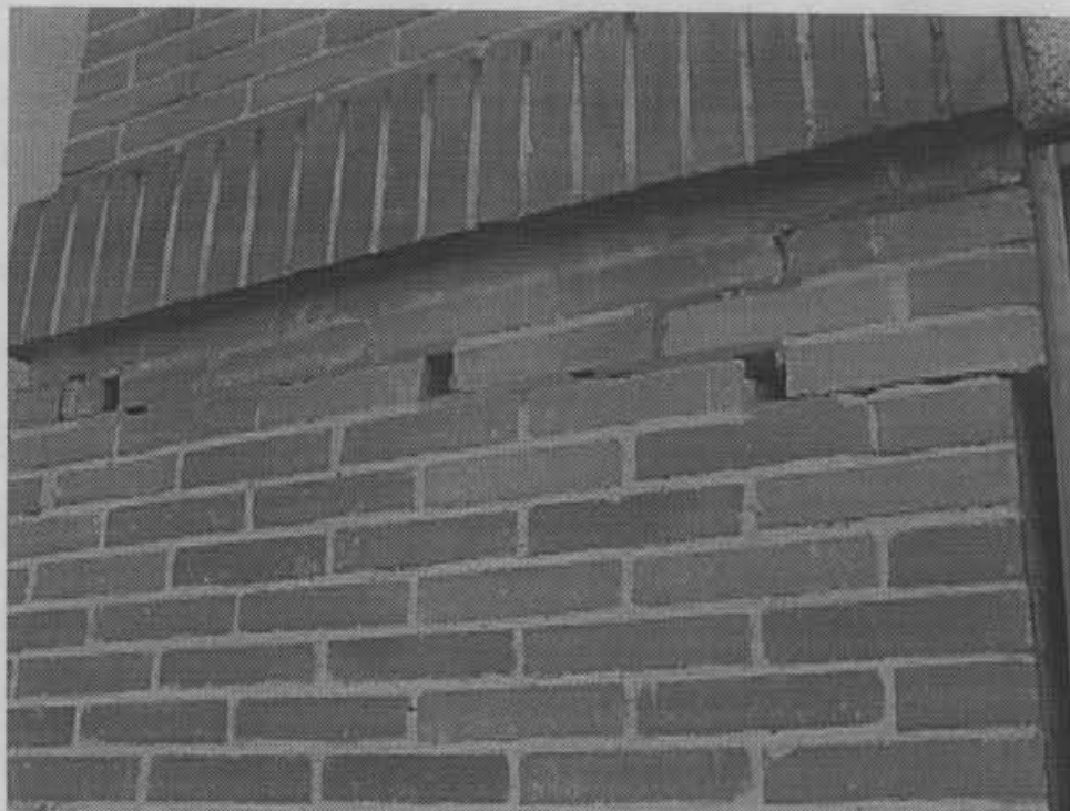
Fotografía No. 5. Fracturamiento de los muros que conforman la caseta de acceso a la urbanización.
