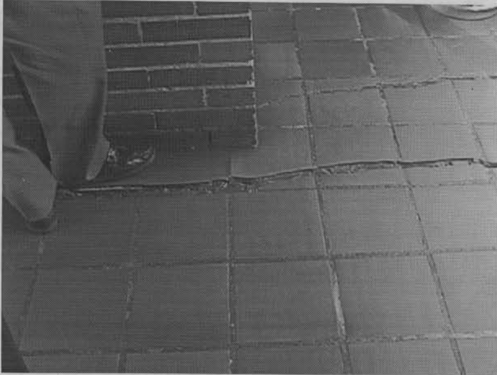
Fotografía No. 7. Agrietamiento y hundimiento del piso de la caseta de acceso. En este sector no se dejó la junta de dilatación que existe entre las dos etapas, por lo tanto, debido al movimiento de los edificios que conforman ambas etapas, el piso de la caseta no resistió de la misma forma estos desplazamientos.
