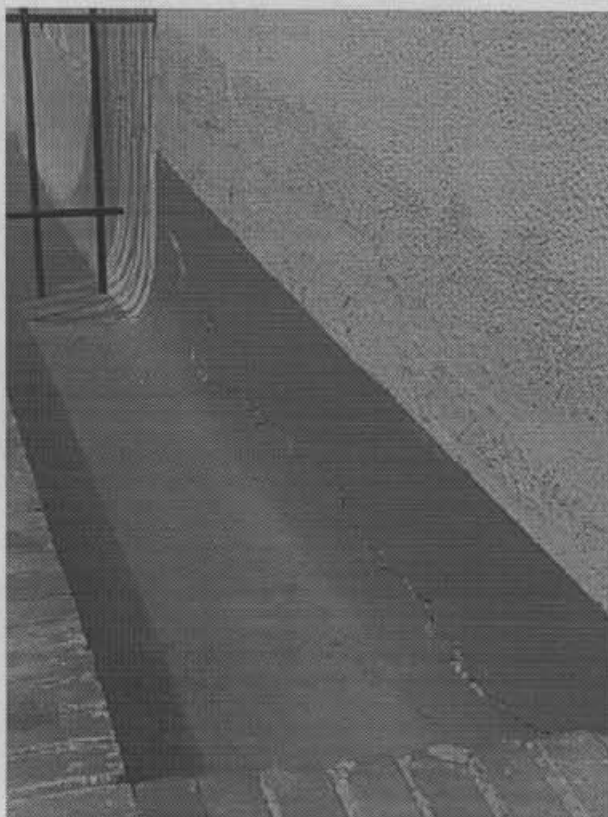
Fotografía No. 4. Grietas y humedades en el apartamento de primer piso adyacente a la caseta de entrada a la urbanización.
