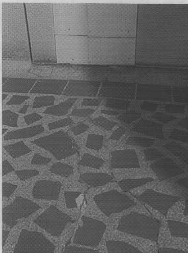
Fotografía No. 2. Acceso al salón comunal. Nótese el flanche o platina metálica y las grietas en el piso.
