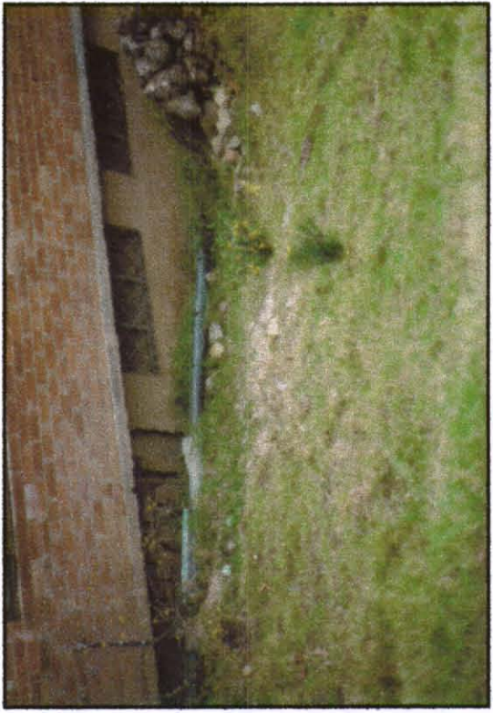
FOTOGRAFIA 3 (R3040F8) VISTA DESDE LA PARTE SUPERIOR DEL TALUD, DEL TRAMO FALTANTE DE MURO EN GAVIÓN
