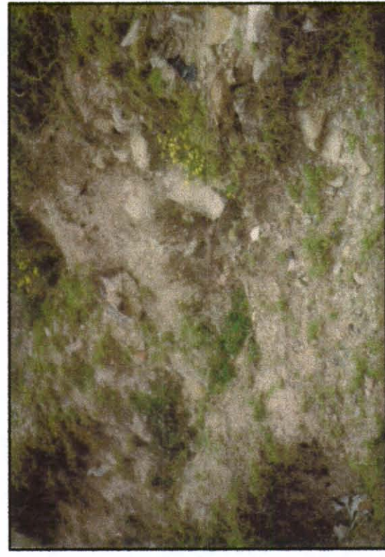
FOTOGRAFIA 5 (R3040F11) APARIENCIA DEL MATERIAL QUE CONFORMA LA SUPERFICIE DEL TERRENO EN EL TRAMO FALTANTE DE MURO EN GAVIÓN. CORRESPONDE A UN LIMO ARENOSO, DE COLOR HABANO CLARO, CON PRESENCIA DE ESCOMBROS Y BASURAS
