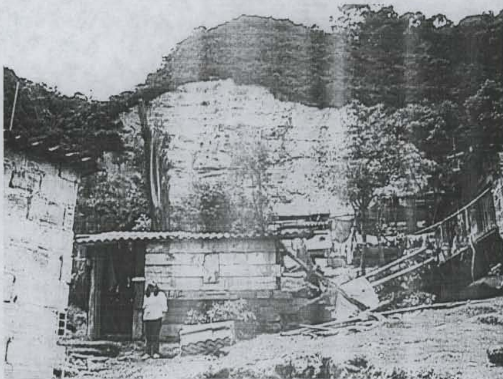
Fotografía No. 1. Escarpe rocoso del cual se extrajo durante algún tiempo la arenisca y arcillolita que hacen parte de la Formación Bogotá. La altura aproximada es de unos 30 m y la longitud de la cara descubierta del escarpe es de unos 40 m aproximadamente.
