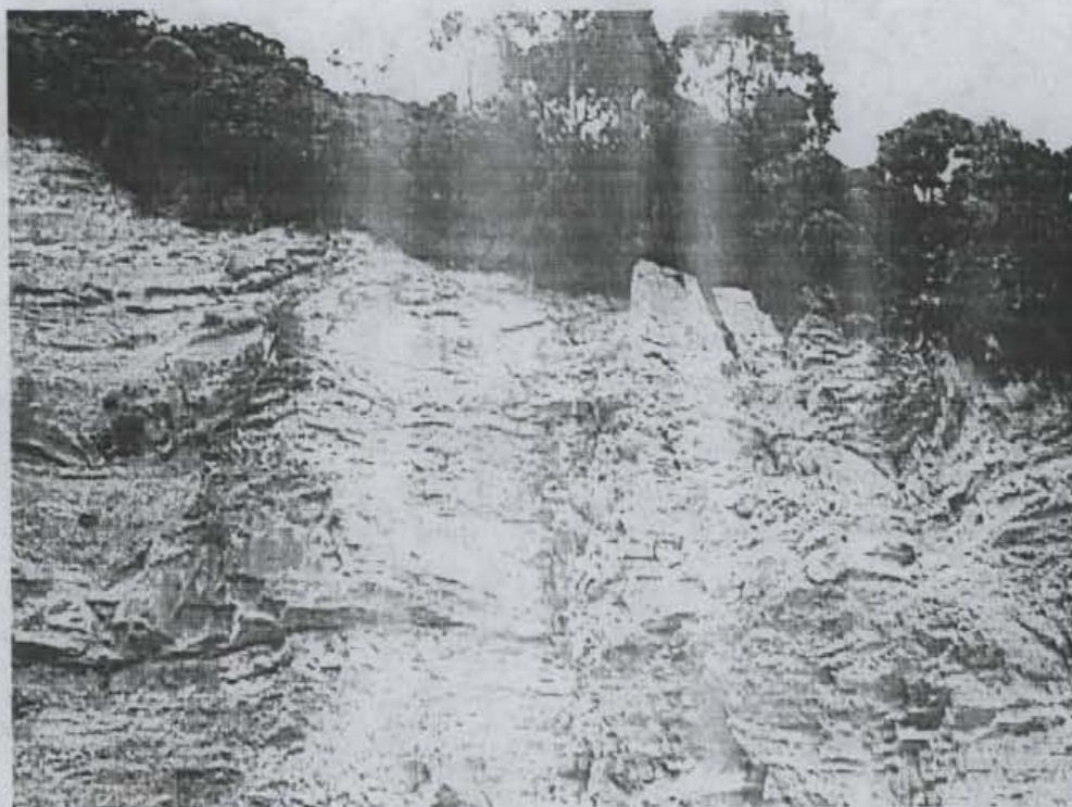
Fotografía No. 2. Detalle de la generación de bloques debido al diaclasamiento del macizo rocoso, muchos de los cuales ya han caído y otros tantos se encuentran en inminente caída.
