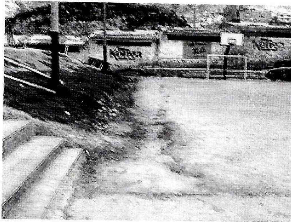
Fotografía 3. Parte superior del talud, margen izquierda de la quebrada Limas. Se observa la zona de infiltración de agua lluvia por el precario drenaje de la cancha.
