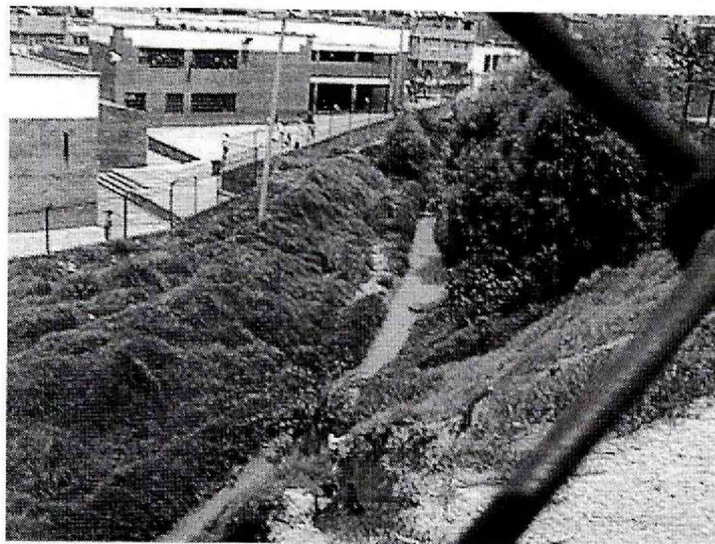
Fotografía 4. Vista desde la parte superior del talud, margen izquierda de la quebrada Limas desde el cerramiento, el cual se encuentra directamente en la corona del deslizamiento. Al fondo se observa las edificaciones de la Escuela San Francisco
