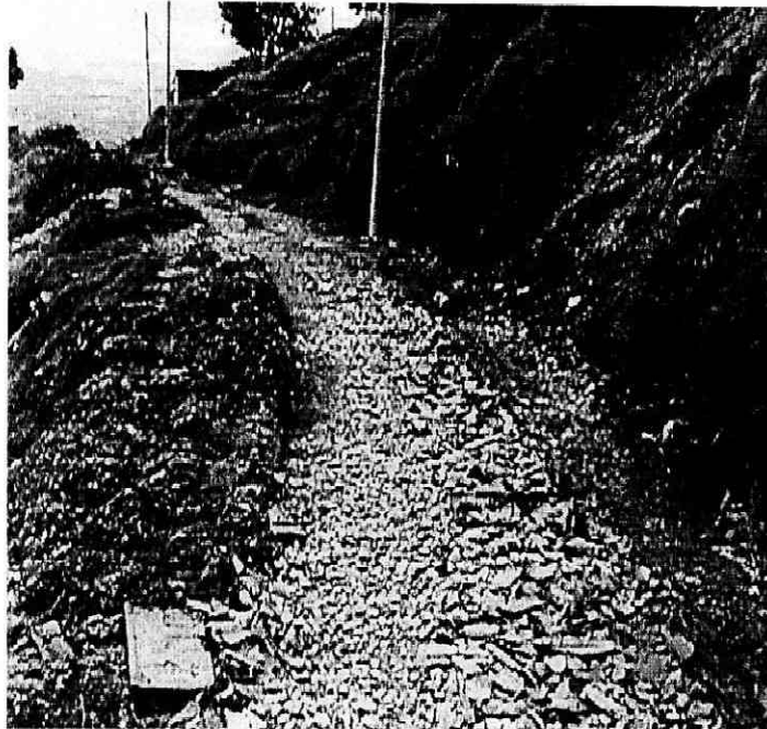
Fotografía 1. Vista de la 1ª vía de acceso al barrio El Dorado (superior). Se presentan pequeños desprendimientos de tierra que obstaculizan el recorrido y la pérdida de soporte de la banca de la vía. Obsérvese los rellenos colados en la banca de la vía.
