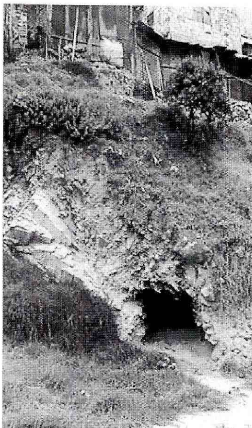
Fotografía 4. Zona 1. Parte inferior del barrio. Se observan socavones ejecutados para explotación minera facilitando la inestabilidad de la ladera.
