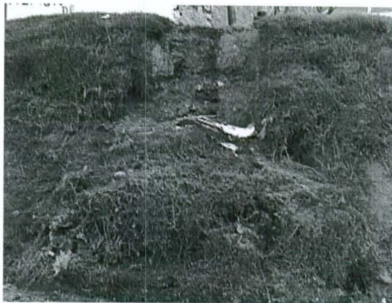
Fotografía 2. Desprendimiento puntual de tierra hacia la banca de la vía. Se observan los materiales de relleno heterogéneo sin compactación.
