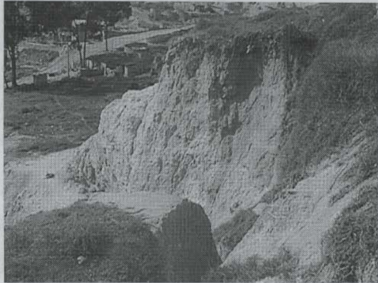
Fotografía 1. Parte superior del talud de corte. Se observa procesos acelerados de erosión y meteorización del macizo rocoso
