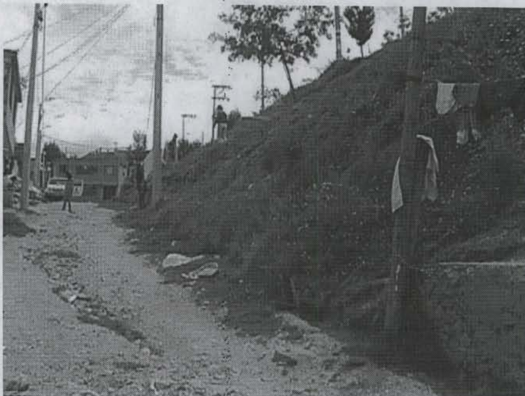
Fotografía No. 1. Detalle de un tramo del talud limitado por la vía inferior y superior. En este sector se observan algunos problemas puntuales de inestabilidad del terreno originados principalmente por la acción erosiva de las aguas lluvias.
