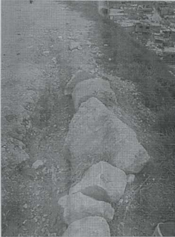
Fotografía 2. Parte superior de la ladera. Cuneta de la vía existente con condiciones inadecuadas de drenaje
