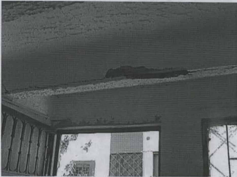
Fotografía No. 1. Vivienda con nomenclatura calle 36G Sur No. 3-70. Se observa el agrietamiento de las viguetas que sostienen el techo de la vivienda.
