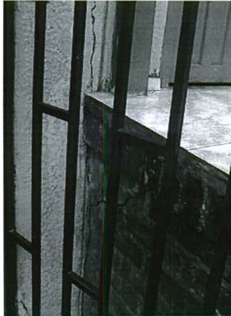
Fotografía 1. Agrietamiento en la junta de dilatación y en el cambio de nivel de las viviendas.
