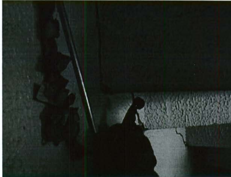
Fotografía 2. Interior de la vivienda de la Carrera 14ª bis No. 49-42 sur. La escalera presenta una grieta longitudinal que separa la misma del muro.
