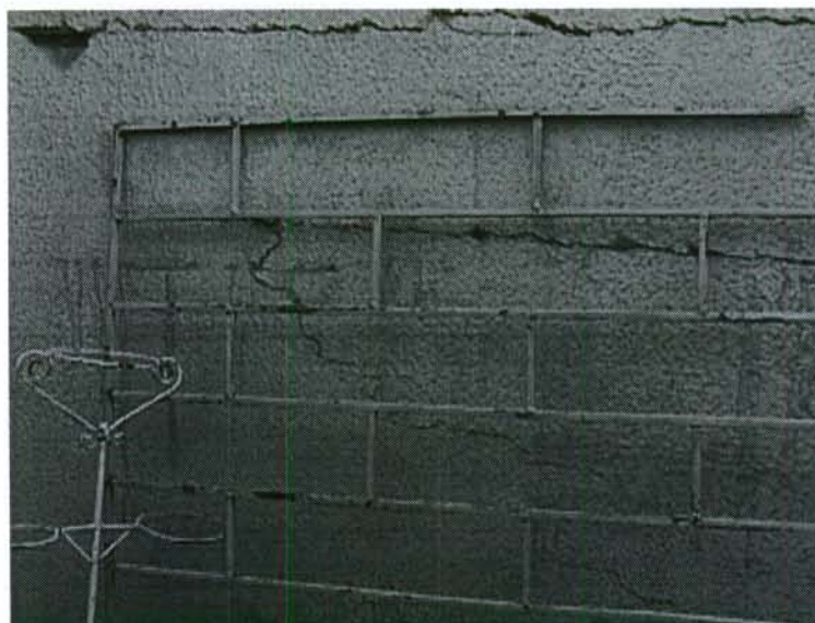
Fotografía 6. Interior de la vivienda Carrera 14ª No. 49-23 sur. Agrietamiento longitudinal, vertical y pandeo del muro del patio en el primer piso.
