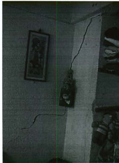
Fotografía 7. Interior de la vivienda Carrera 14ª No. 49-23 sur. Agrietamiento transversal que afecta toda el área del muro y la zona de la columna en el segundo piso
