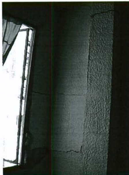
Fotografía 8. Interior de la vivienda Carrera 14ª No. 49-23 sur. Agrietamiento del muro de fachada de 2º piso creando algunos bloques sueltos.
