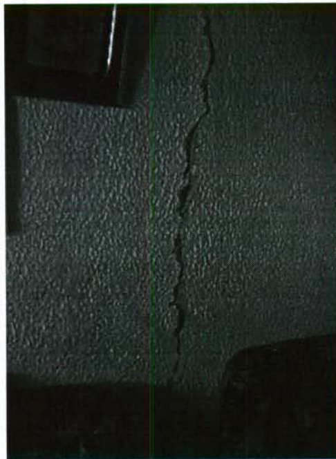
Fotografía 2. Interior de la vivienda de la Carrera 14ª bis No. 49-42 sur. Se observa una grieta vertical a lo largo del muro de mampostería de primer piso
