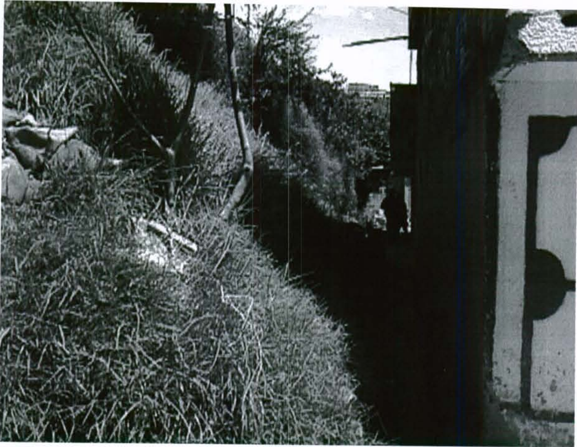
Fotografía No. 2. Este talud corresponde a la carrera 1 Este y tal como se observa, existen viviendas tanto en la corona como en la base del talud.
