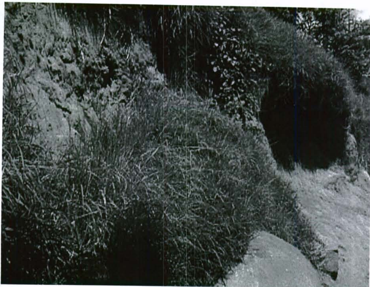
Fotografía No. 4. Detalle del tipo de material que conforma el talud mencionado. Se observa como la falta de cobertura vegetal facilita que los procesos de meteorización y erosión se aceleren, ocasionando la inestabilidad puntual de algunas zonas.
