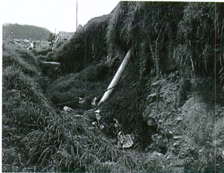
FOTOGRAFIA 4. Vista hacia la parte superior de la Diagonal 50, desde la ladera contigua al talud del evento. Tuberías de acueducto y alcantarillado sin ningún tipo de protección
