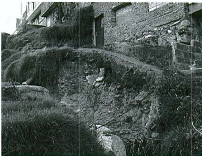
FOTOGRAFIA 2. Vivienda ubicada en el No. 7-57 este, la cual se encuentra a menos de 1,0 m., zona de camino de los habitantes del sector, conformado sobre la cobertura vegetal.
