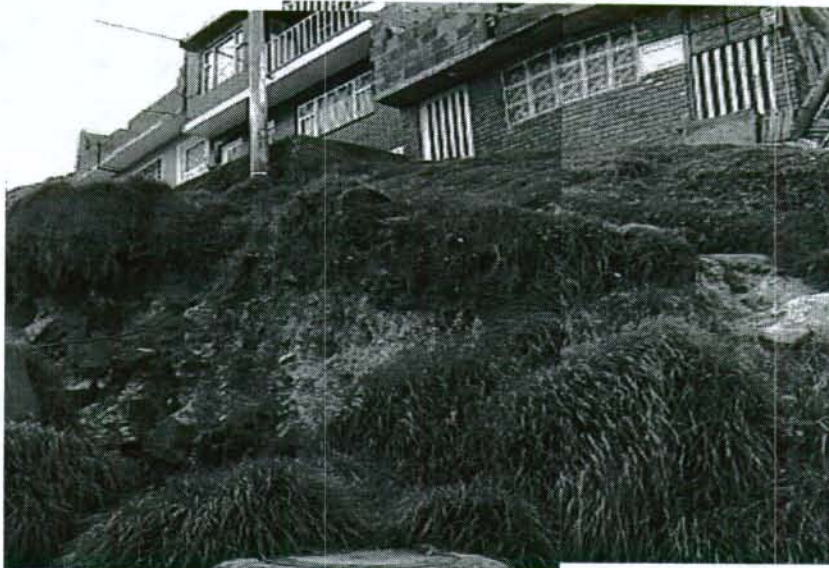
FOTOGRAFIA 1 . Vista del talud del evento, donde se aprecia el pozo del sistema de alcantarillado. En la parte superior de la fotografía se observa la placa de cimentación de la vivienda vecina y el poste.
