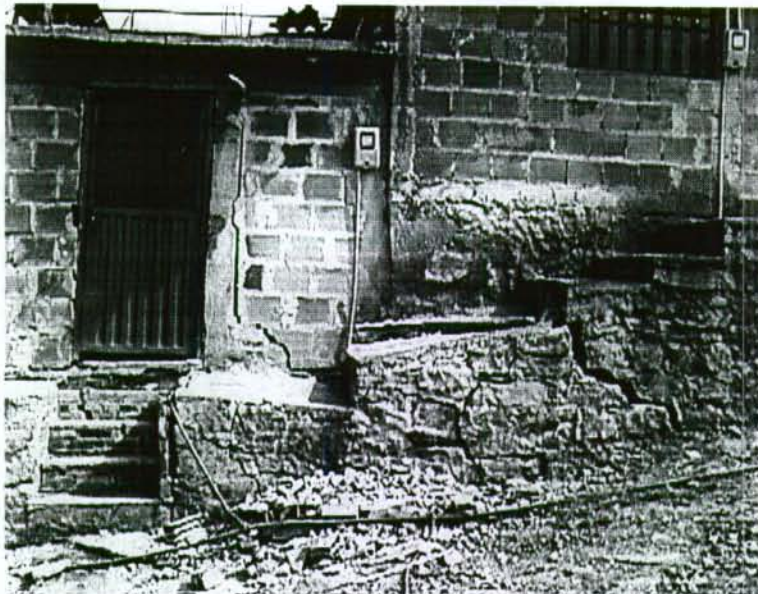
Fotografía 1. Fecha: Marzo 17. Límites de las viviendas No. 4 y 5. Los habitantes de vivienda No. 4 desmontaron la ornamentación (puerta verde y ventana) debido a que las deformaciones eran rápidas dañando estos elementos.
