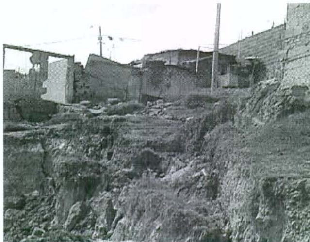
Foto 4. Barrio Santa Elena - tomada el 19 de Octubre de 2000. Avance retrogresivo del fenómeno de inestabilidad y afectación estructural de las viviendas localizadas en la zona de influencia.
