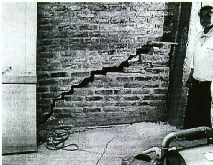
Fotografía 2. Interior de la vivienda No. 3 la cual es la más afectada por las deformaciones afectando los muros divisorios, piso y columnas de concreto reforzado. Esta zona fue evacuada por el riesgo de colapso de la estructura.
