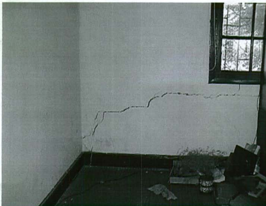
FOTO No.5: Agrietamiento de muros de segundo piso, vista interna.
