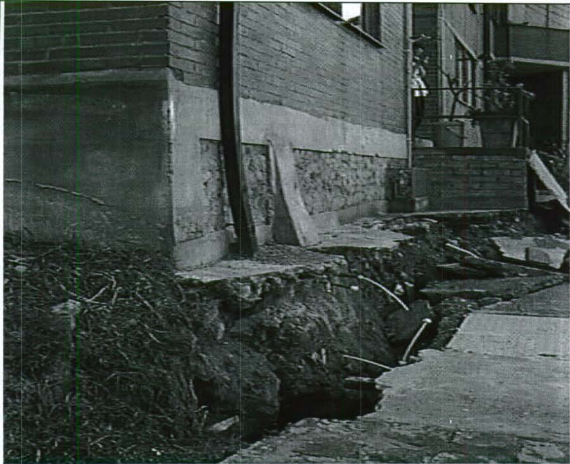
Fotografía No.3. Detalle de la esquina afectada. El bajante que se observa aportó de manera continua un porcentaje alto de agua al ir fallando con el movimiento progresivo del terreno, la cual fue lavando el material de relleno sobre el cual se apoyó la zapata del edificio.
