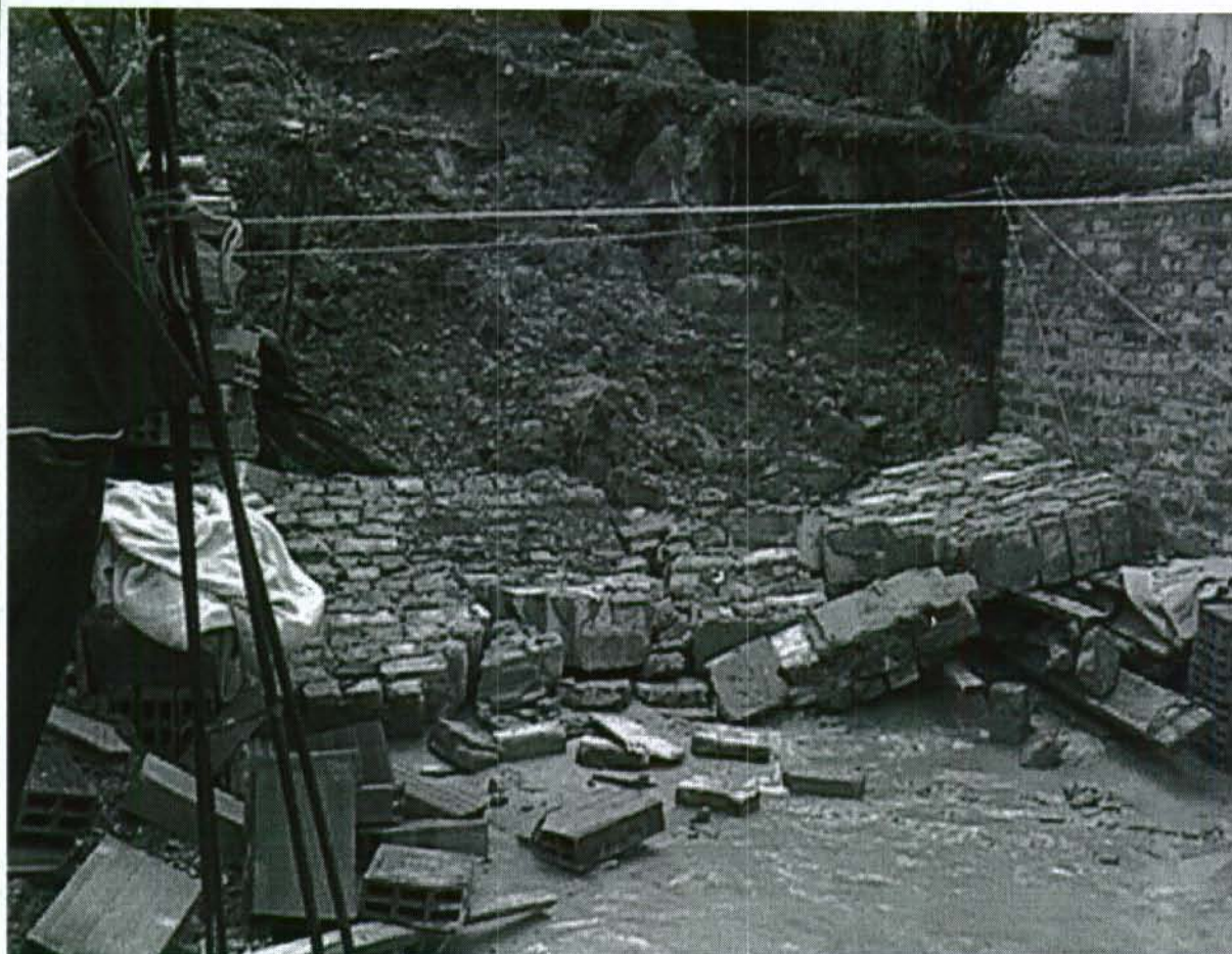
Fotografía No.7. Muro derribado por el empuje del suelo que se deslizó al saturarse con el aporte del agua del sector, tanto lluvias como de las tuberías de acueducto.
