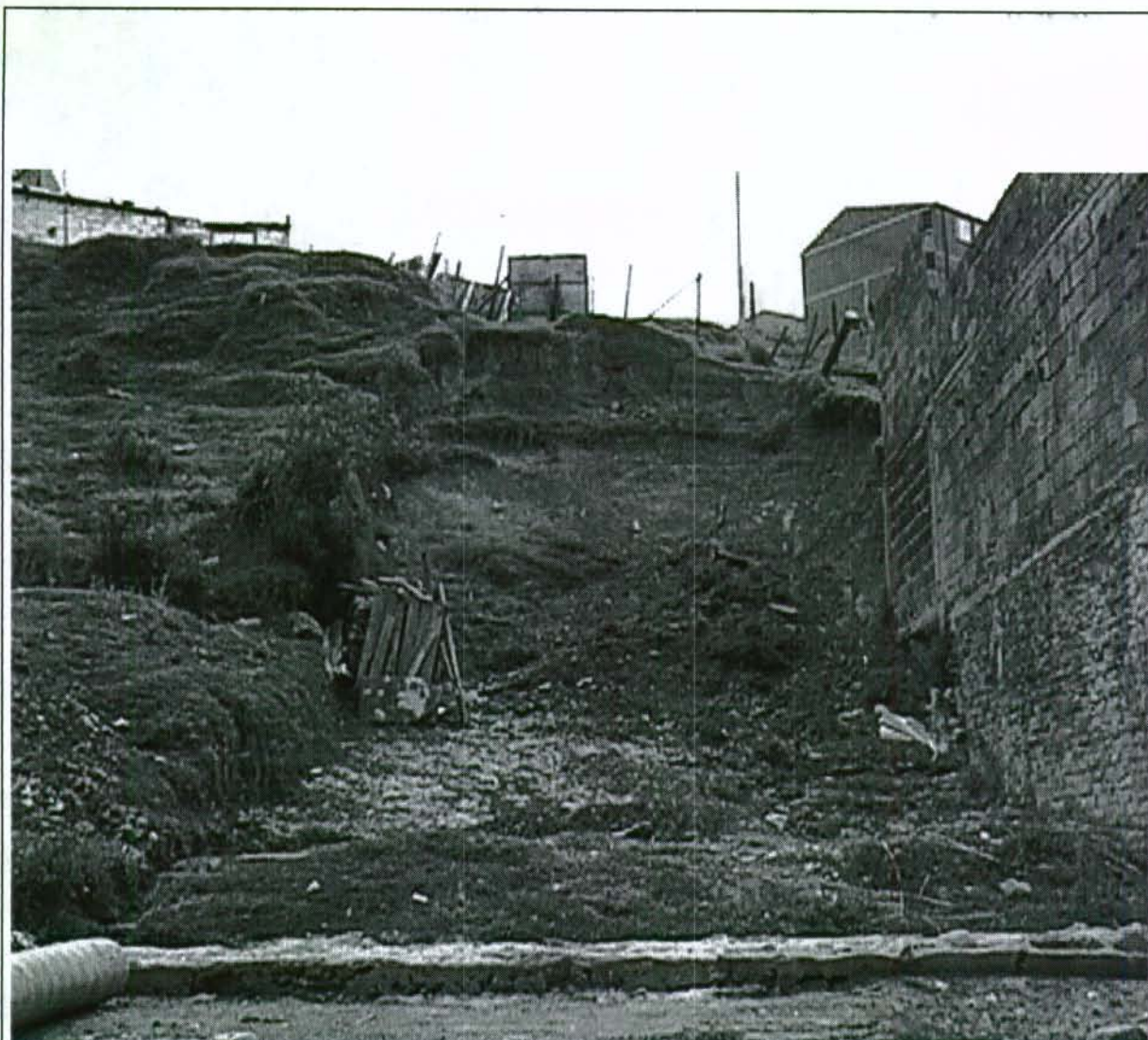
Fotografía No.6. Excavación antitécnica realizada por el propietario del lote en la parte baja de la ladera, lo cual ocasionó una liberación de esfuerzos, contribuyendo al movimiento del terreno descrito en las fotografías anteriores.
