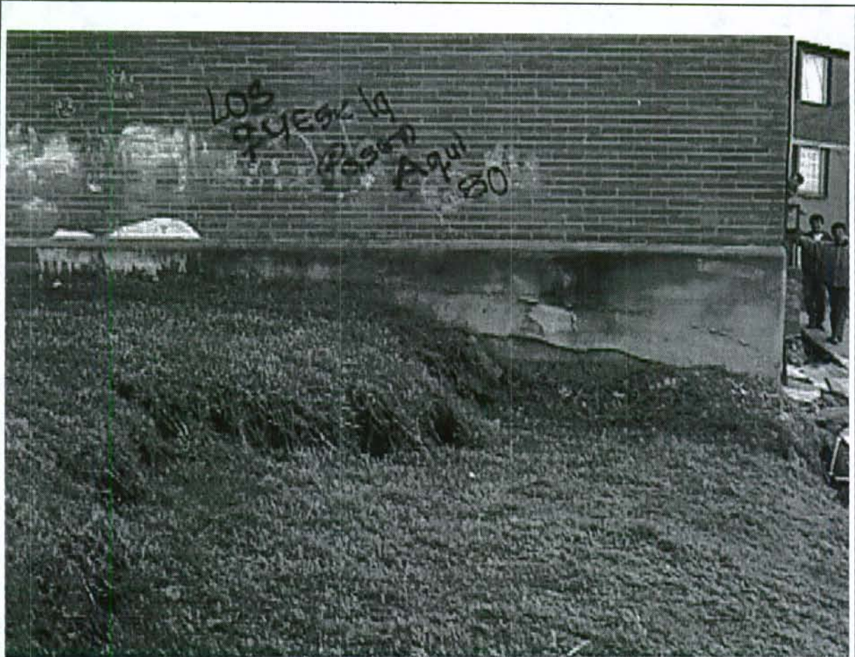
Fotografía No.2. Detalle del desgarre del terreno, el cual evidencia una aceleración en el movimiento de reptación, ocasionado principalmente por la saturación del suelo superficial.
