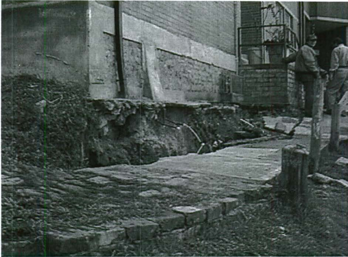
Fotografía No.1. Edificio perteneciente al conjunto residencial Altos del Sol, el cual fue afectado por el movimiento súbito del terreno al amanecer del 10 de enero. La esquina más afectada fue la oriental.
