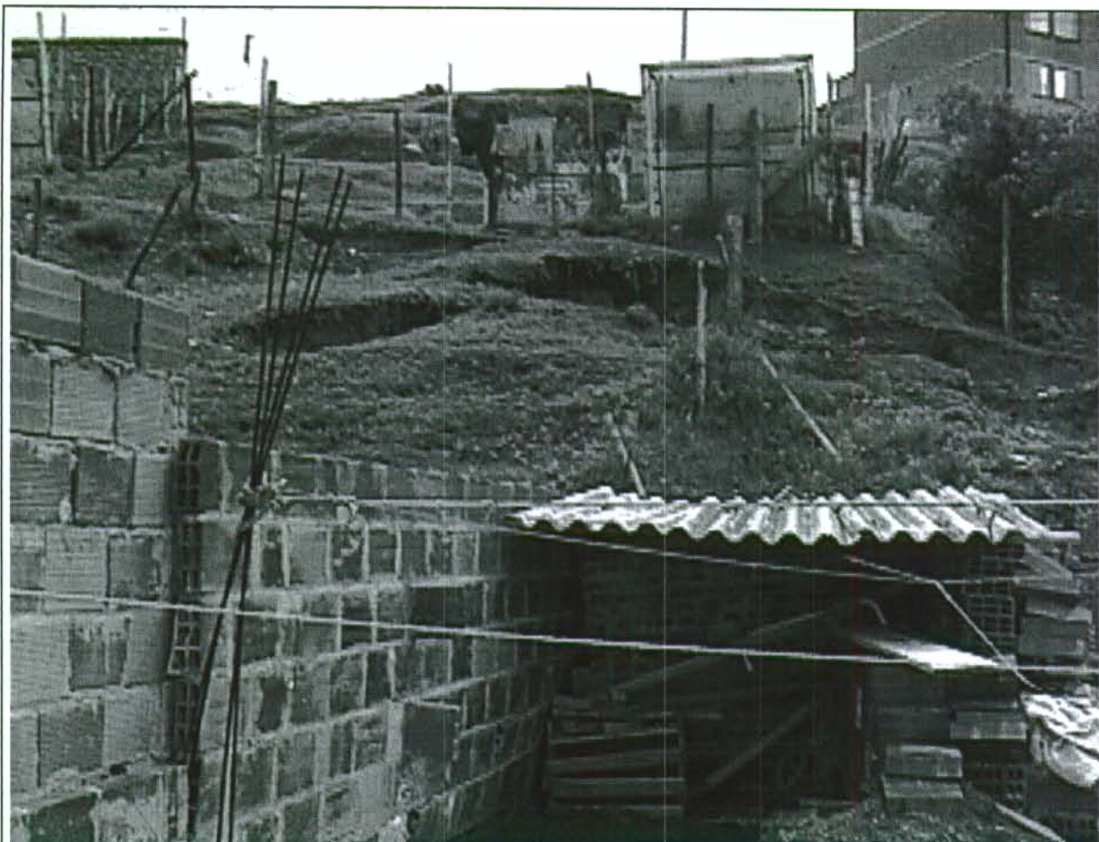
Fotografía No.8. Muro lateral de la vivienda localizada en la parte inferior de la ladera, que soportó en mayor grado el empuje del terreno, aunque de todas formas también falló.
