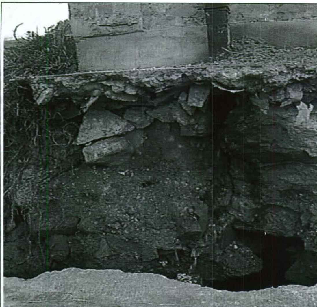
Fotografía No.4. Obsérvese el cimiento del edificio, el cual consiste en una pequeña zapata en mampostería, para la cual no se profundizó mayormente, apoyándola sobre material de relleno. Se observa parte del cimiento corrido en concreto ciclópeo bajo muros.
