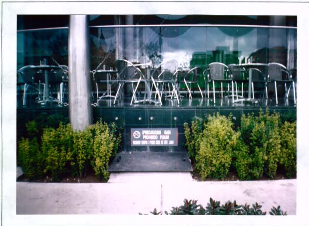
FOTO No. 6. Detalle de la tapa del otro tanque subterráneo de Gas, Edificio Portobelo. Se observa la placa de advertencia acerca de la presencia de gas.
