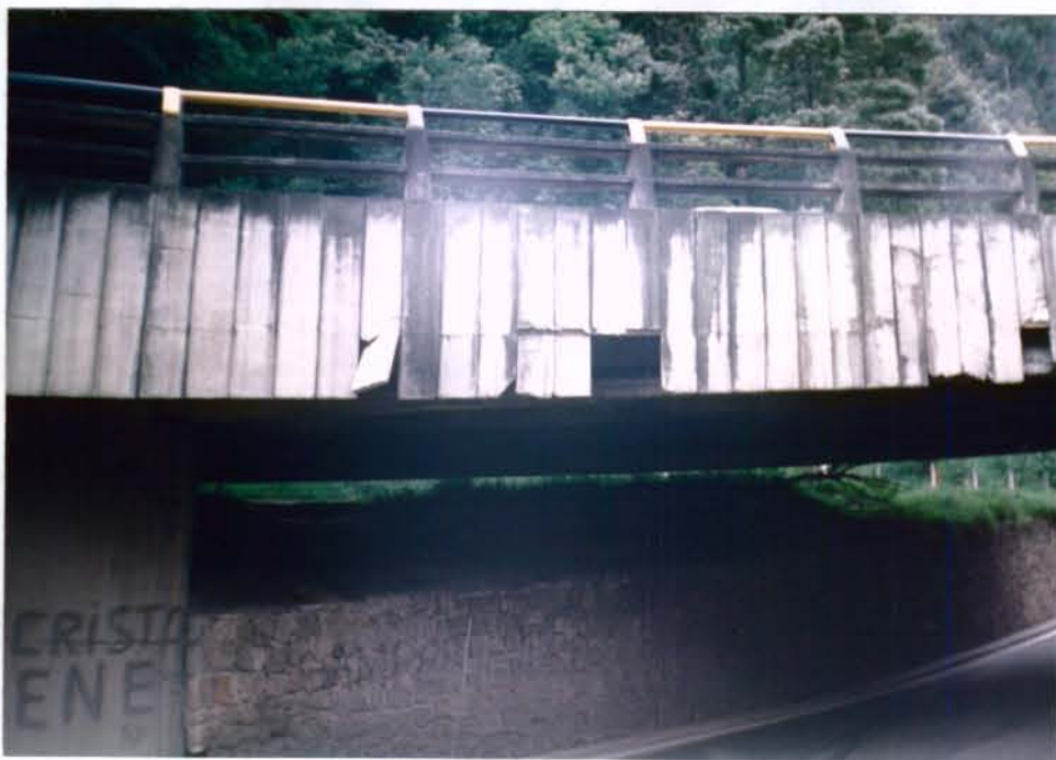
FOTO No. 2 : Losas de concreto fracturadas.
