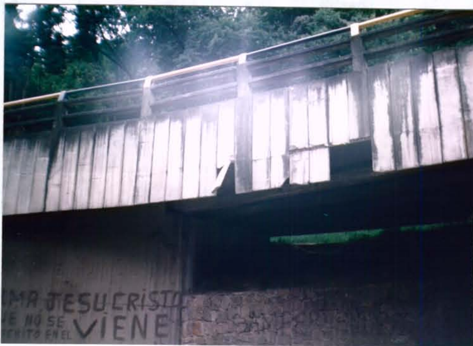
FOTO No. 1 : Losas de concreto fracturadas.
