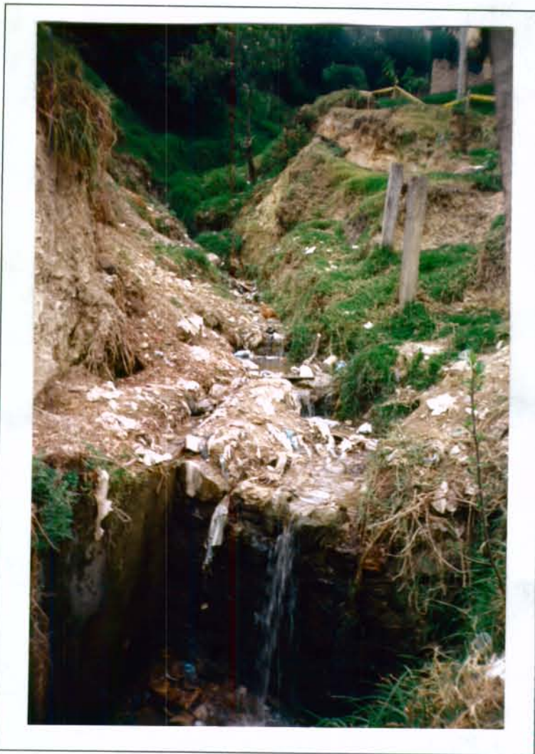
Fotografía No. 4 - Punto No. 8 Detalle del estado actual de la quebrada en inminencia del cruce con la vía.
