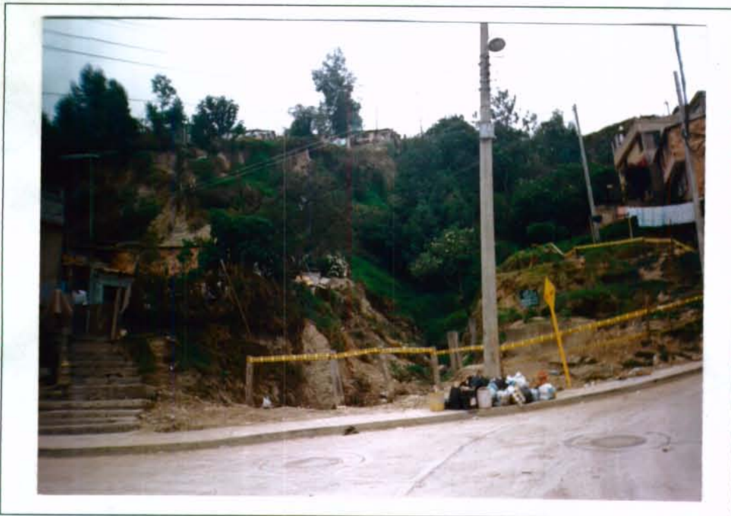
Fotografía No. 1 - Punto No. 8 Vista hacia aguas arriba de la quebrada Cerro Sur, justo en el punto de estudio. El talud de la derecha en la fotografía (margen izquierda) está siendo intervenido por la Fundación Bacatá. Nótese el grado de erosión en la margen derecha.
