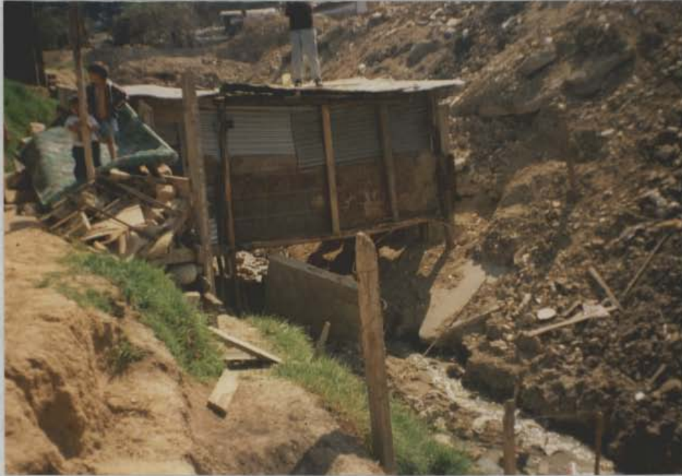
FOTOGRAFIA 1 (Rollo 8352/30). La vivienda se encuentra construida dentro de la zona de ronda o área de afectación del caño La Marranera y su resistencia es mínima debido a que fue construida sin las especificaciones técnicas requeridas.
