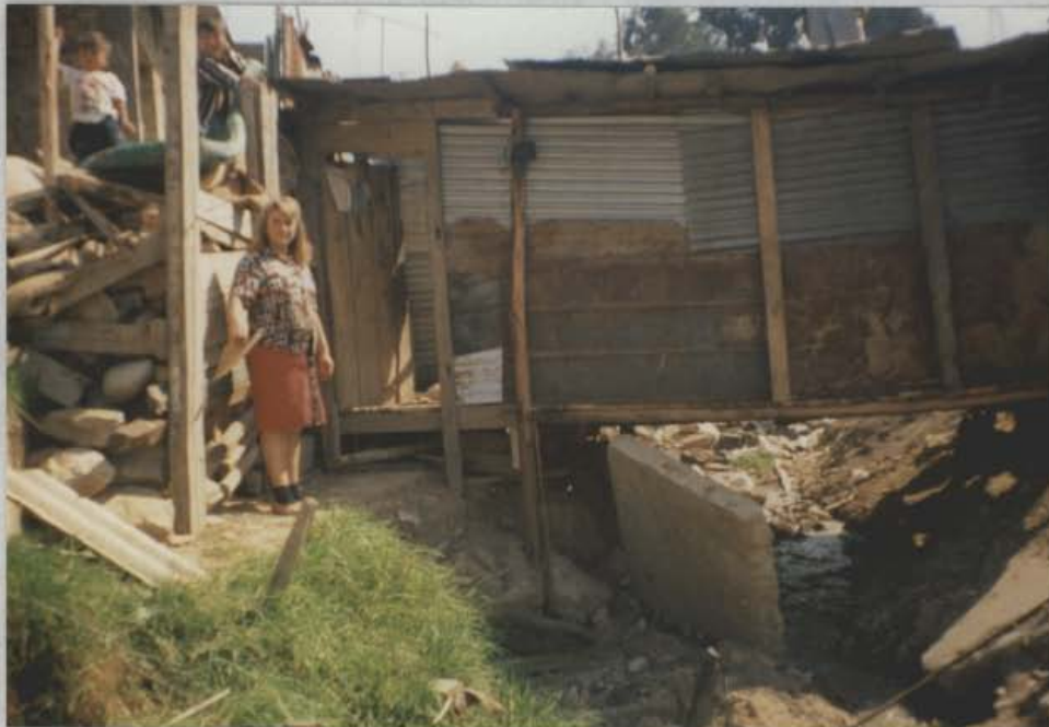
FOTOGRAFIA 2 (ROLLO 8352/31). La construcción corresponde a una vivienda de una (1) planta, sin vigas y columnas de amarre, sin cimentación, con una cubierta liviana (teja de zinc), entrepiso en madera y estado malo. Por lo que el asentamiento es de tipo tugurial.
