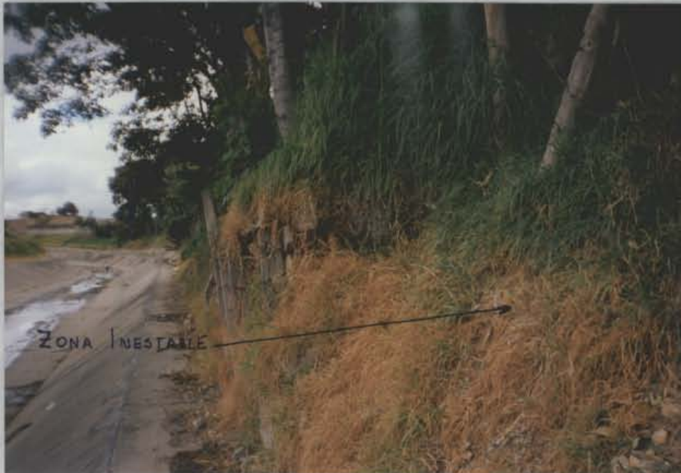
FOTO 1 Se observa el talud de la margen izquierda del canal Río Seco, el cual presenta evidencias de inestabilidad (R9742 F0).
