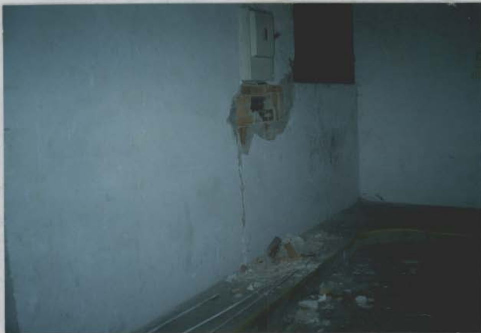
FOTO 2 En la parte izquierda de la foto se encuentra el muro del punto fijo y en la parte derecha el muro del tanque de almacenamiento de agua potable, en el limite se observa el desplome de parte del pañete y en la parte inferior se aprecia el desplazamiento vertical de la placa (costado norte).
