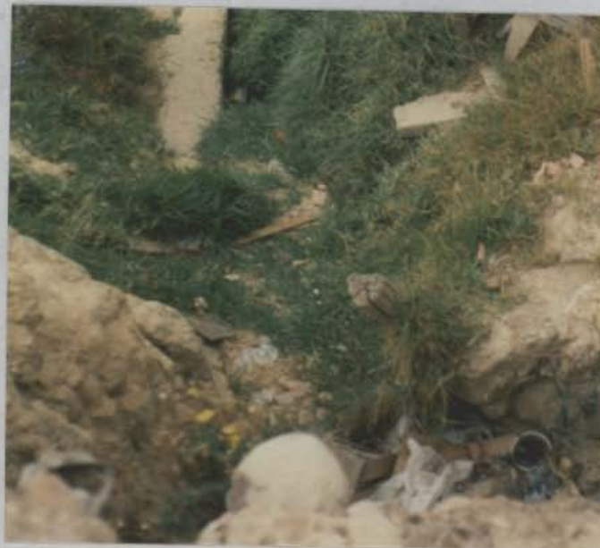
FOTOGRAFIA 2 (Rollo 0089/12). El sector no cuenta con servicio de alcantarillado, las aguas negras son evacuadas por medio de tuberías construidas artesanalmente.
