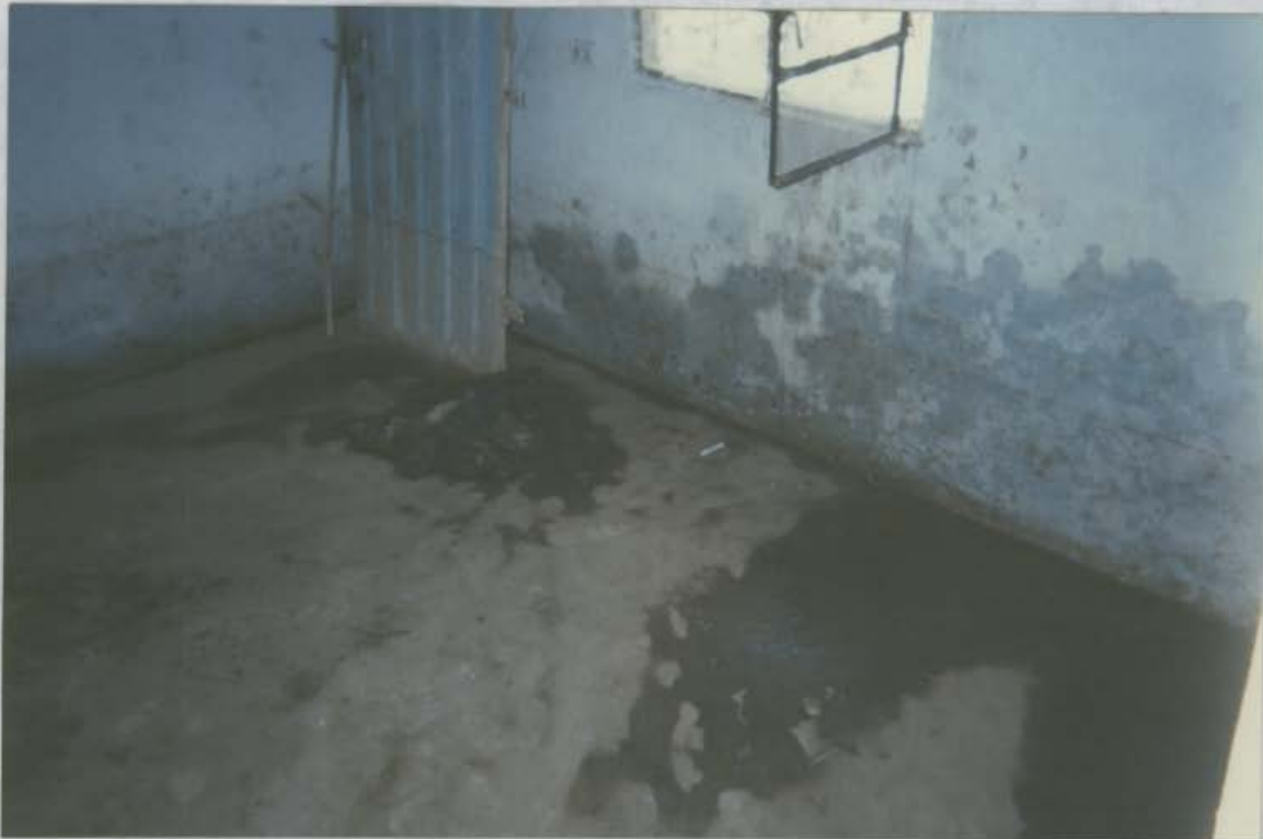
Foto No. 1. Obsérvese en la pared humedad dejada por la inundación de aguas negras
