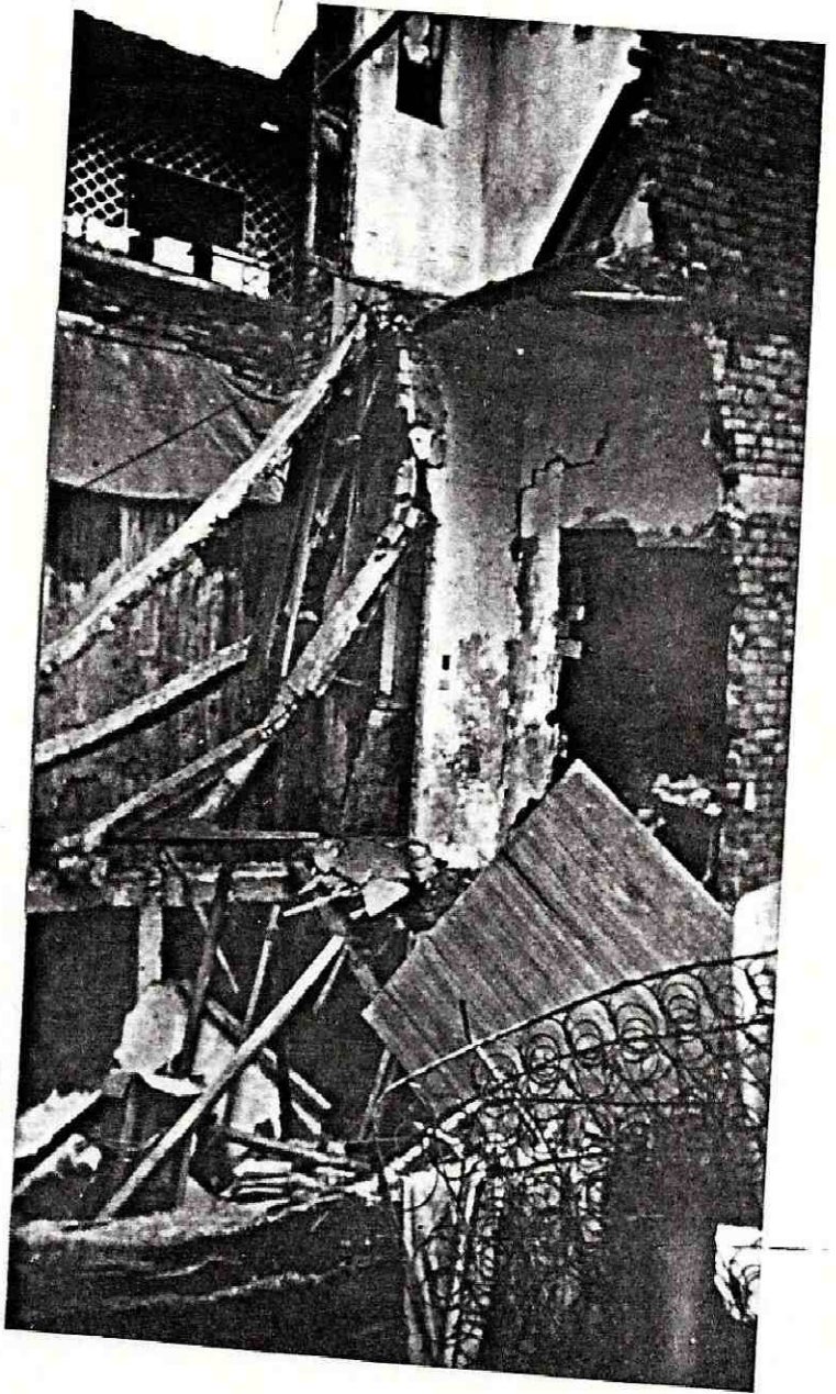
Foto No. 2. Restos de la casa, después de desplomarse la parte central.
