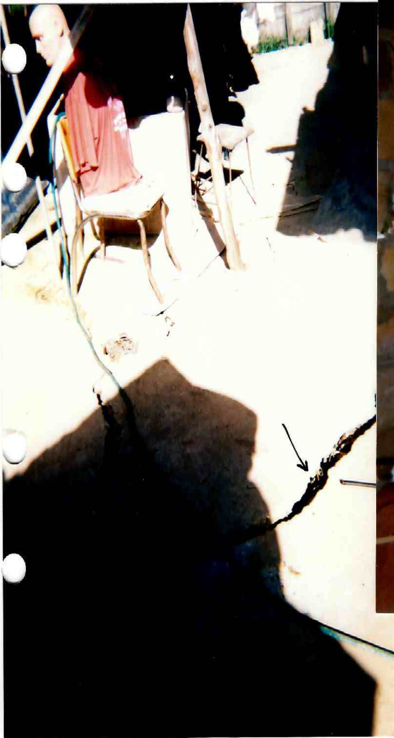
Foto No. 3. Grietas en el piso del patio.
