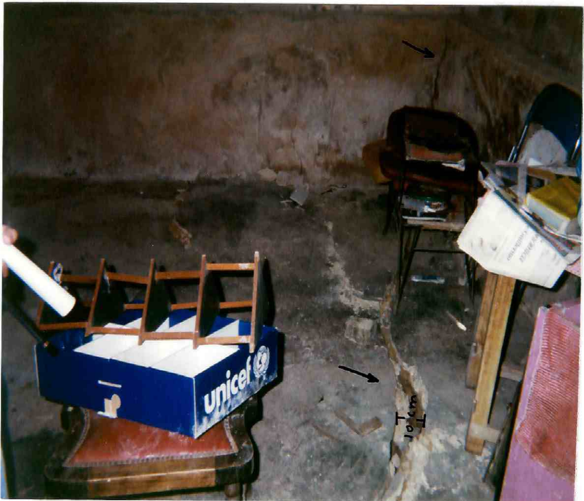
Foto No. 1. Grieta que atraviesa todo el piso y las paredes de la habitación.
