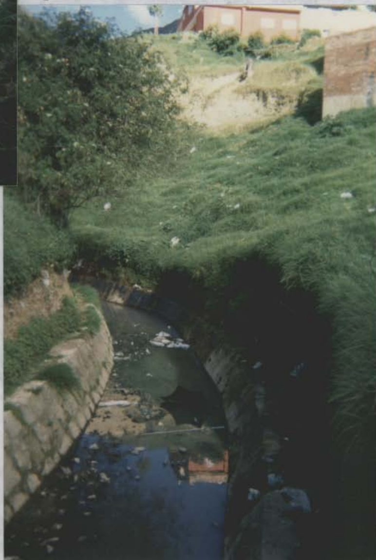
Foto No. 4 Aguas estancadas en el canal colector. Obsérvese el alto grado de contaminación.
