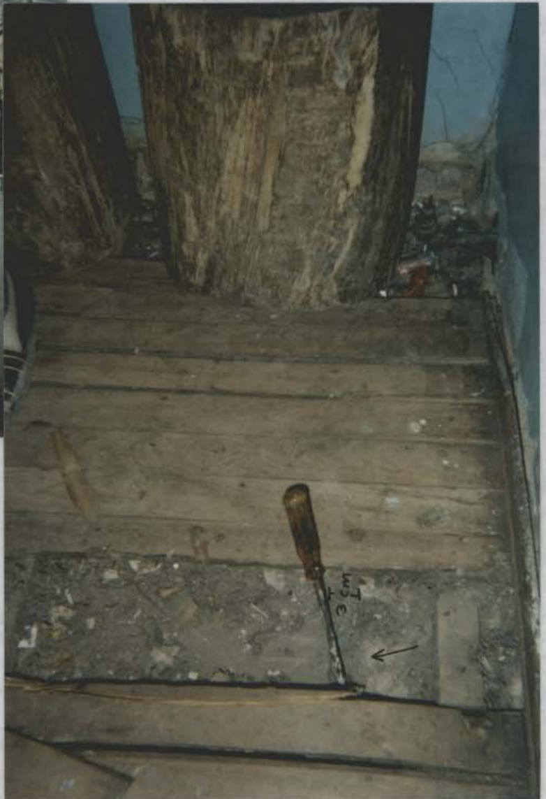
Foto No. 16 El destornillador está metido en una grieta del piso, con separación de 3 cm.
