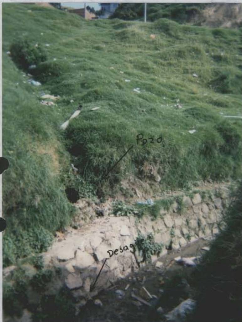
Foto No. 3 Caja de aguas negras entregando directamente al canal.
