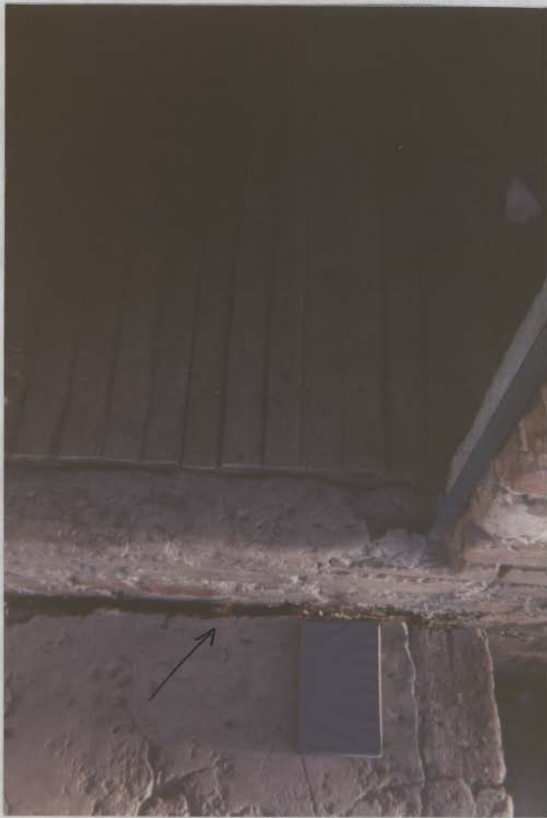
Foto No. 17 Dilatación en las escaleras de acceso de la vivienda.
