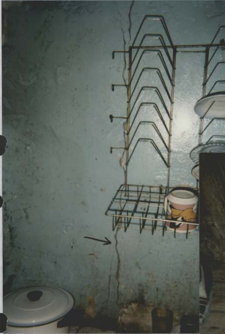
Foto No. 15 Grieta vertical con separación de 1 cm. en la pared de una de las viviendas del sector de la antigua mina de carbón.
