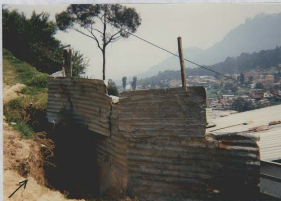
Foto No. 9 Deslizamiento en la parte posterior de la casa con dirección Diag. 4A # 9-27 Este.
