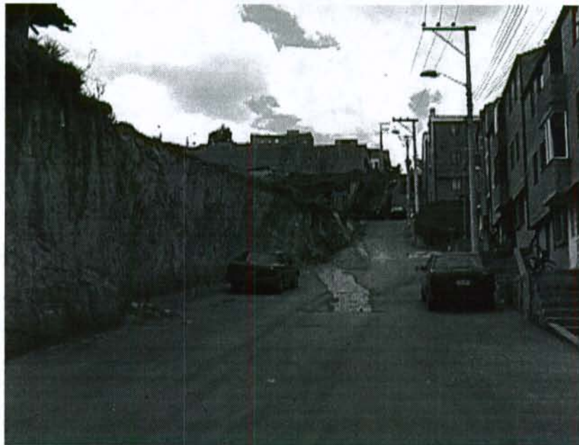
FOTOGRAFIA 2. Obsérvese al fondo la caída de materiales y en algunos puntos la presencia de negativos
