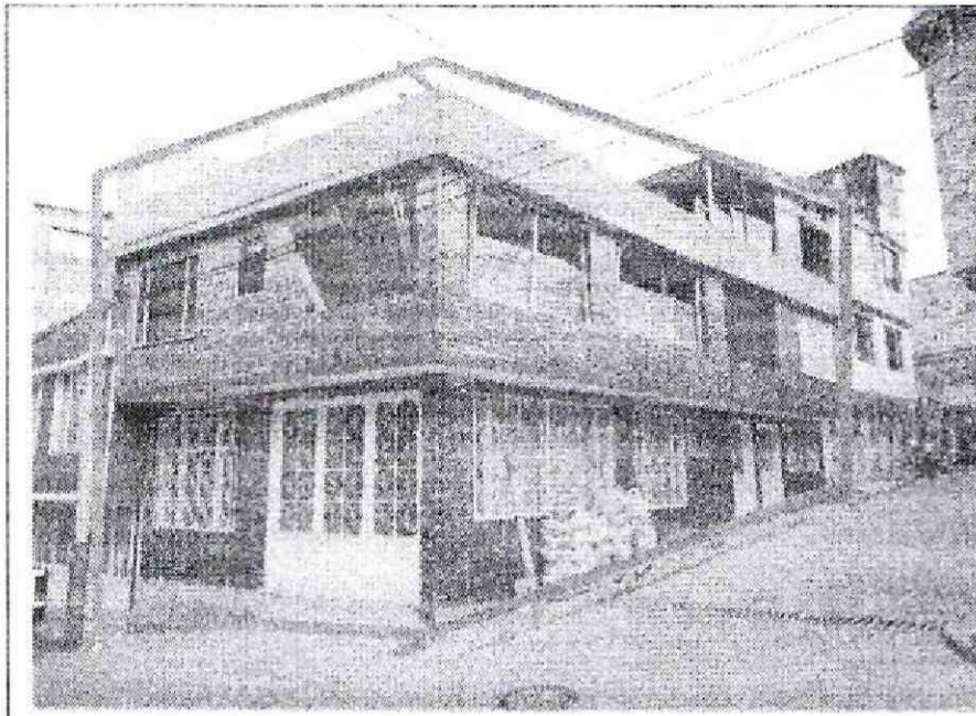
Fotografía No. 1. Predio objeto de visita en el cual se encontró una casa de dos (2) pisos construida en mampostería parcialmente confinada. El segundo piso se encontró en remodelación u obra negra; se evidencia el comienzo de la construcción de un tercer piso
