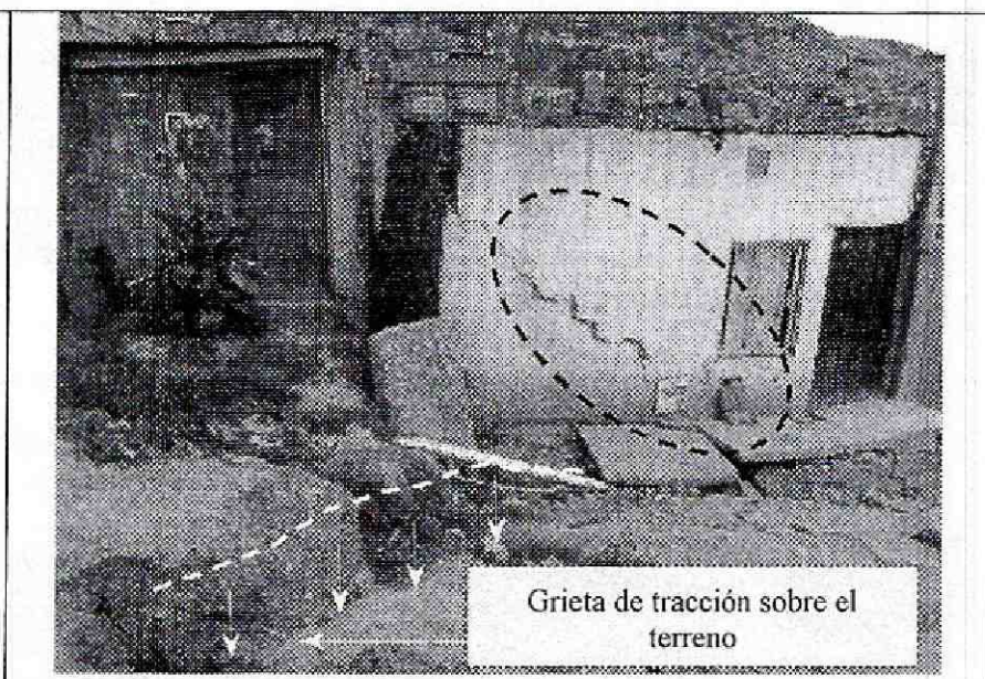
Fotografía 6. Se observan grietas de tracción y afectaciones sobre la vivienda ubicada en el lote 18 de la manzana 24. (Tomada del DI-6511)
