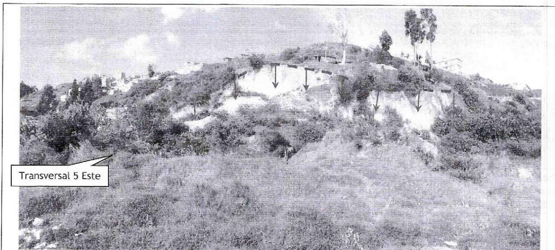
Foto 1. Vista panorámica del proceso de remoción en masa identificado en el Diagnóstico Técnico DI-6224 del Barrio El Dorado de la Localidad de Santa Fe, el cual compromete la transitabilidad y funcionalidad de la vía correspondiente a la Transversal 5 Este.
