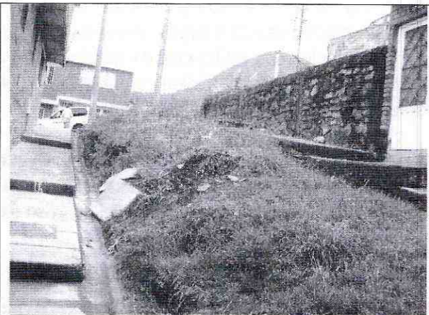
Fotografía No. 2. Vista sobre la TV. 13B Este, es una vía de uso peatonal, se evidencia un sector consolidado cuyo uso es principalmente residencial.
