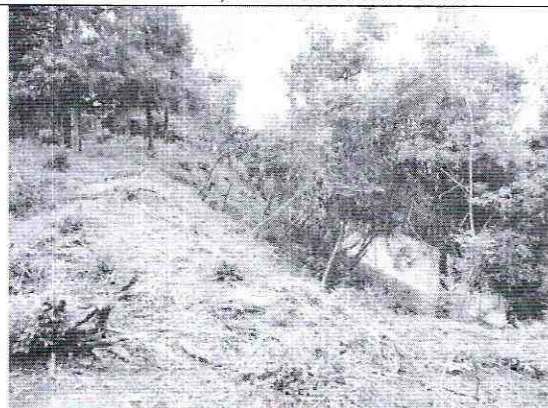
Fotografía No. 17. Vista del predio ubicado en la Carrera 89 No. 147B - 42 IN 3, afectado por reptación
