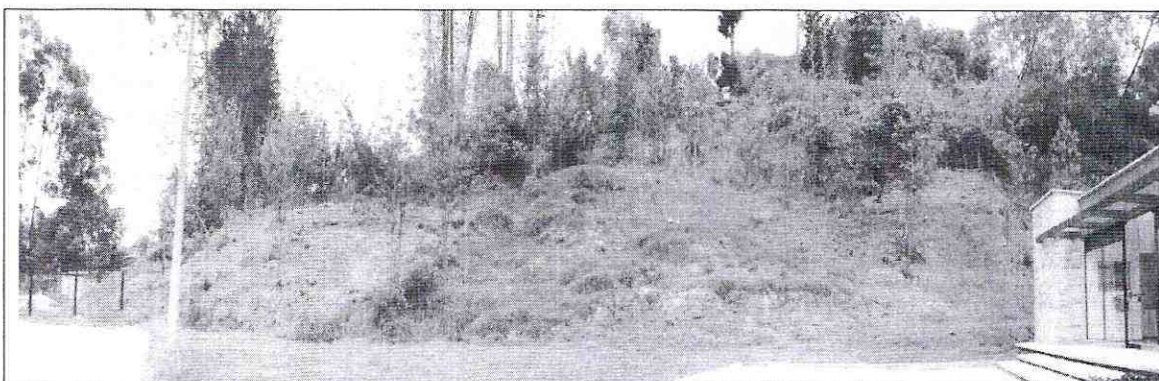
Fotografía No. 1. Panorámica del deslizamiento localizado en el sector oriental del proyecto de la Carrera 87 No. 147 B - 25 In 6.
