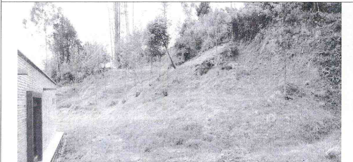
Fotografía No. 2. Detalle del deslizamiento localizado en el sector oriental, justo detrás de la Sala de Ventas del proyecto; se observa el escarpe y la masa deslizada.
