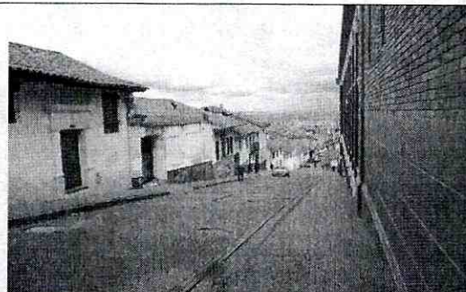
Fotografía No. 4. Vista (E - O) de la Calle 10. Se observa una pendiente media a alta. Se observan edificaciones de 1 y 2 pisos. Se observa vías en adoquín, las cuales presentan algunos hundimientos.
